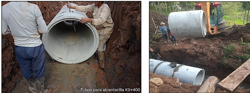
Figura 30 Tubería de Concreto
