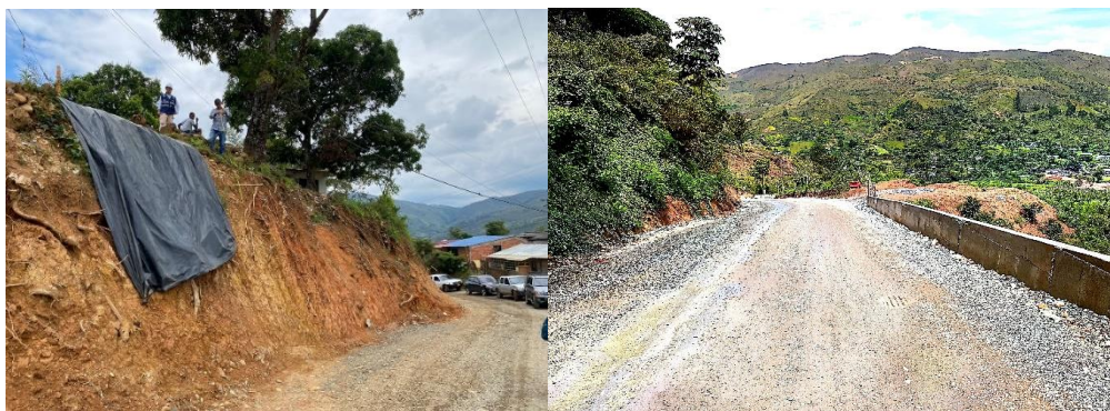
Figura 33. Inestabilidad en taludes.
