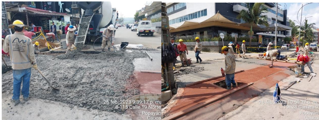
Imagen 46. Vaciado y vibrado del concreto, acabados arquitectónicos - Pompeyano H. San Martín (Archivo personal)
