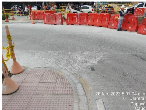
Imagen 62. Losa de concreto afectada (Archivo personal)
