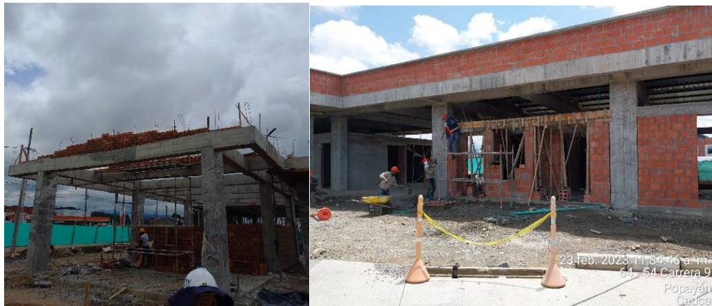
Imagen 57. A la izquierda, viga deflectada del módulo 2; a la derecha, apuntalamiento inadecuado (Archivo personal)
