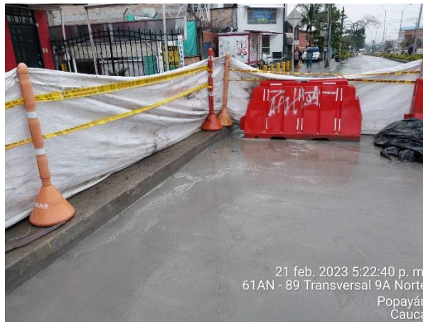
Imagen 61. Empozamiento en el empalme (Archivo personal)
