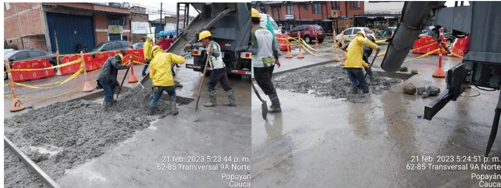
Imagen 64. Alteración de la dosificación del concreto (Archivo personal)
