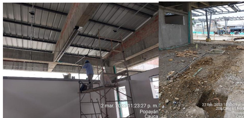
Imagen 21. A la izquierda, instalación de sistema eléctrico para video beam; a la derecha, apantallamiento y caja para acoplar polo a tierra Cooper Well (Archivo personal)
