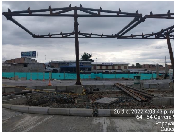
Imagen 63. Pasarela 3 sin aplome (Archivo personal)
