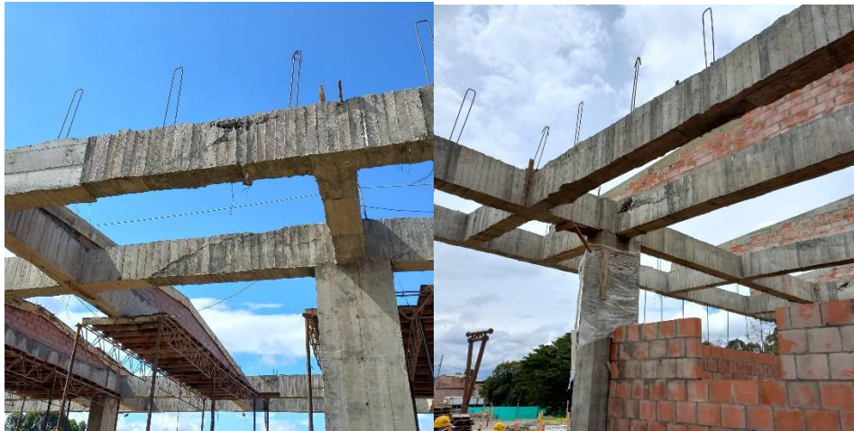
Imagen 54. Vigas aéreas con efecto de hormigueos (Archivo personal)
