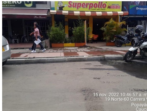
Imagen 70. Exudación del concreto asfáltico
