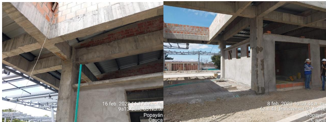
Imagen 56. Hormigueros corregidos en vigas aéreas y columnas (Archivo personal)
