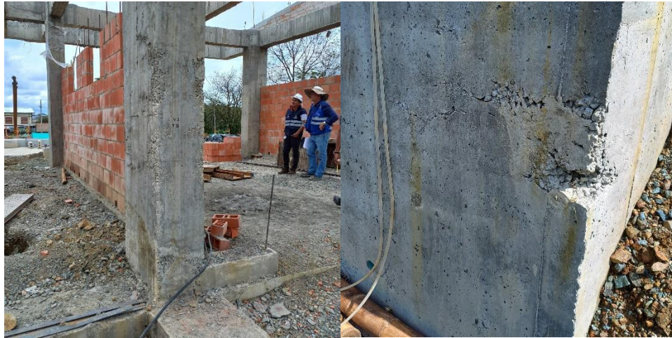
Imagen 55. Columnas y muro de contención con hormigueos (Archivo personal)
