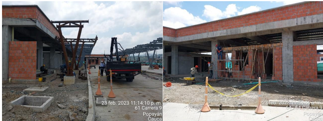
Imagen 17. Vista de muros y parapetos externos, alfajías y fundición de vigas - alfajías (Archivo personal)
