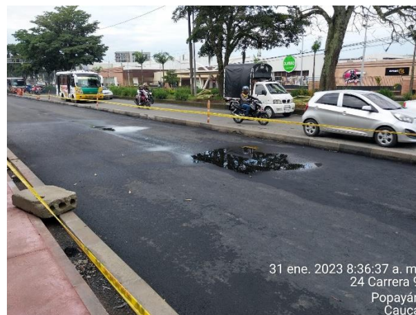
Imagen 69. Empozamiento en la fase 3 (Archivo personal)
