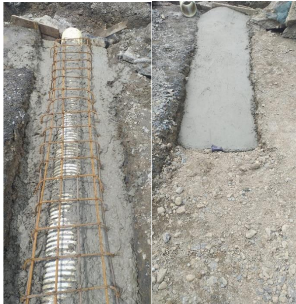
Imagen 47. Cárcamo de protección a tubería de sumideros
