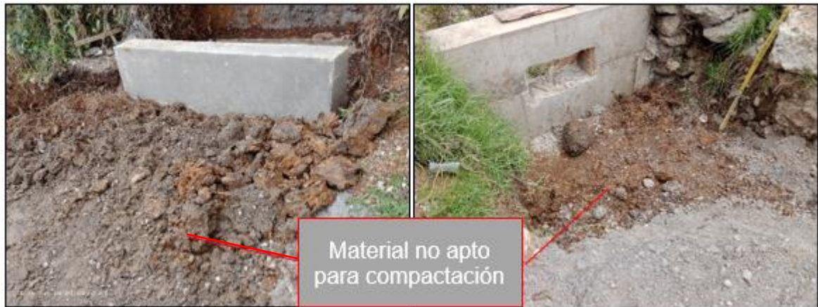
Ilustración 13.24 material no apto para compactación
