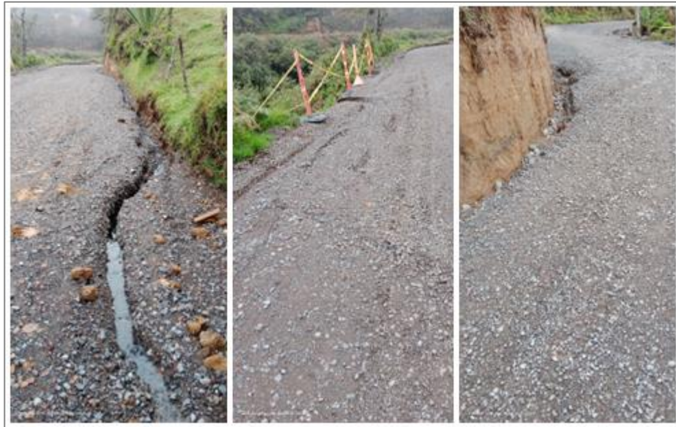
Ilustración 13.31 daños en base granular debido a las lluvias, km4+650
