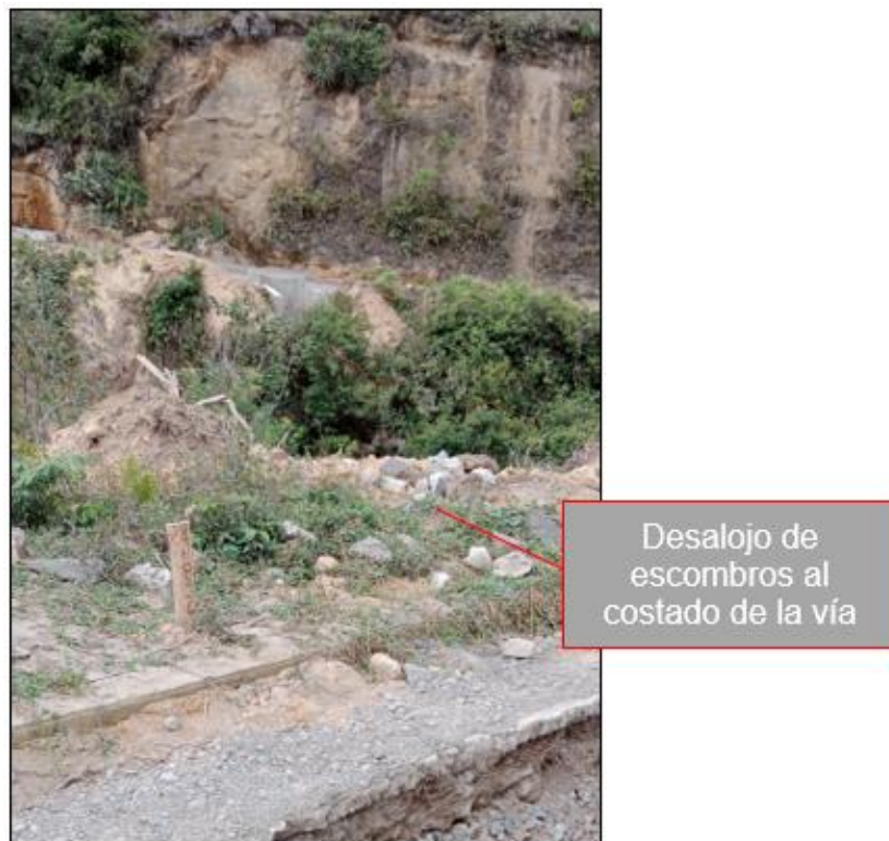
Ilustración 13.14 Escombros de explanación y corte, depositados al costado de la vía
