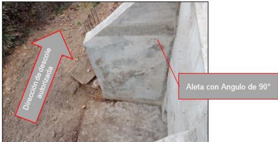
Ilustración 13.39 Descole de alcantarilla que se debe corregir.
