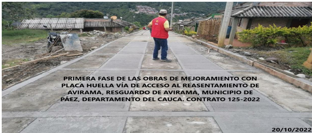
Figura 39: Inspección a las Placas-huellas construidas por la CNK vigencia 2022, Páez Cauca.
