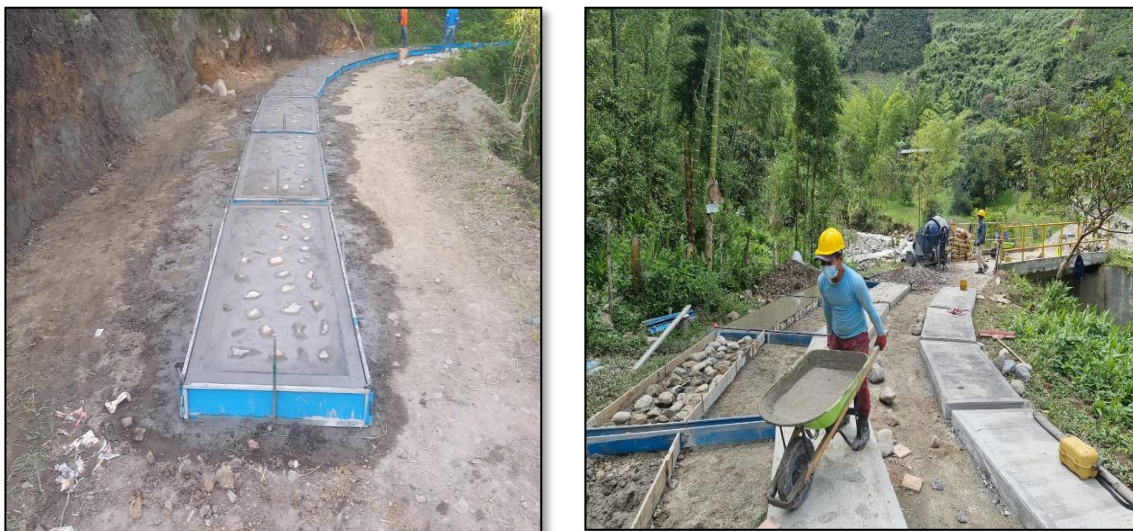
Figura 27: Construcción de las placas de pedraplén, Reasentamiento de El Carmen, Páez Cauca.
