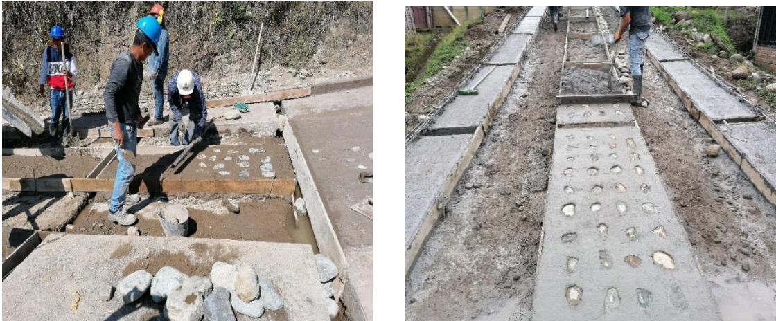
Figura 26: Fundición de las placas de pedraplén, Reasentamiento Minuto de Dios y Mesa de Togoima, Páez Cauca.
