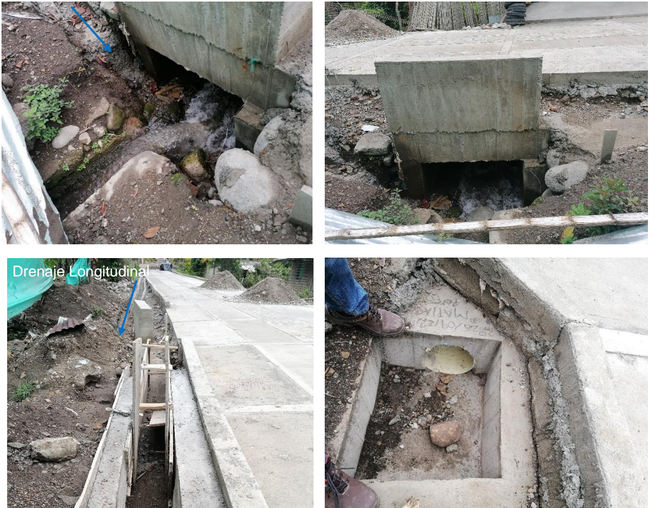
Figura 41: Drenaje transversal y Longitudinal Placa-huella vía al Reasentamiento de Cohetando, Páez - Cauca.
