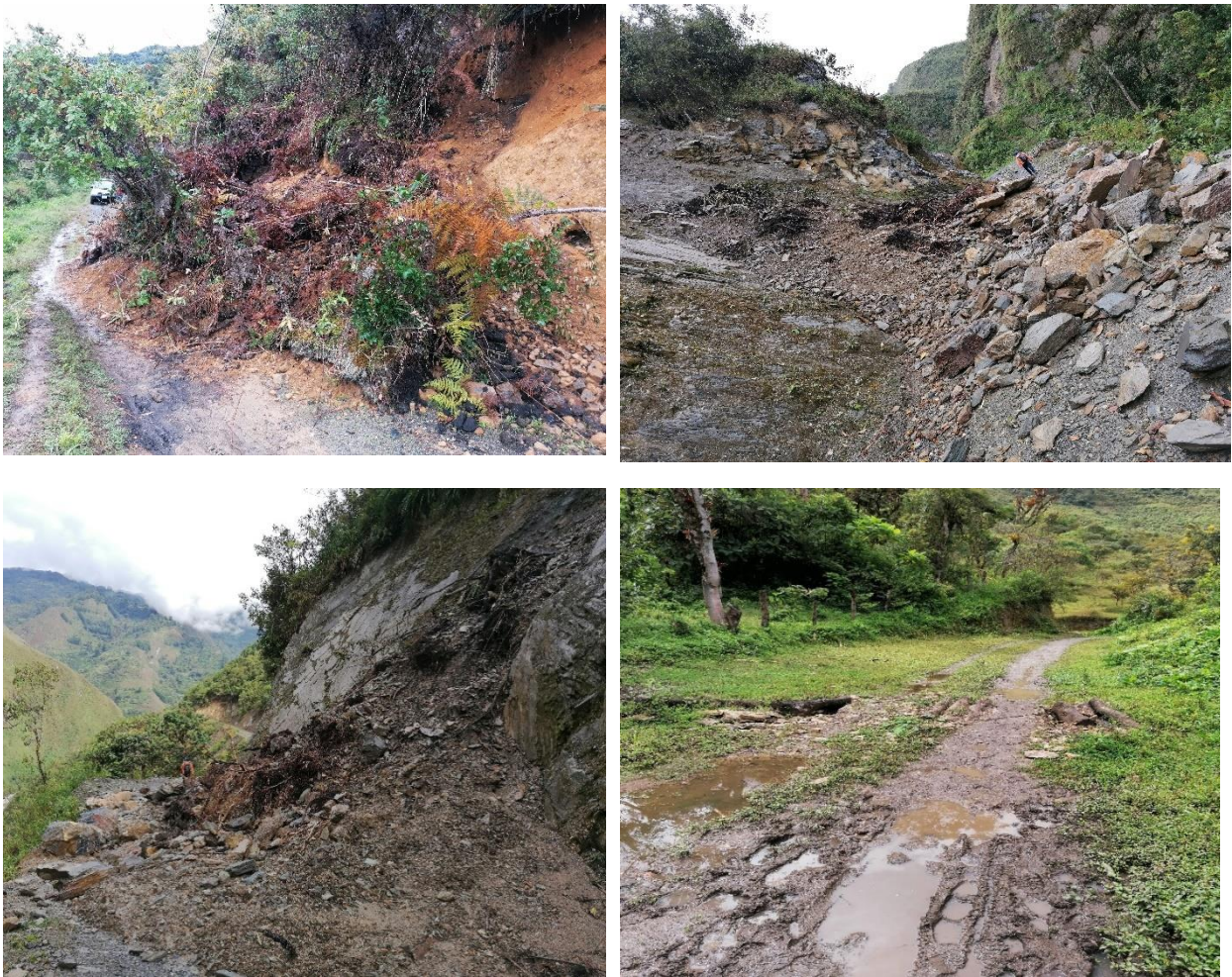
Figura 72: Derrumbes y zonas inestables en el Eje vial hacia la ubicación del Puente Cresta de Gallo.
