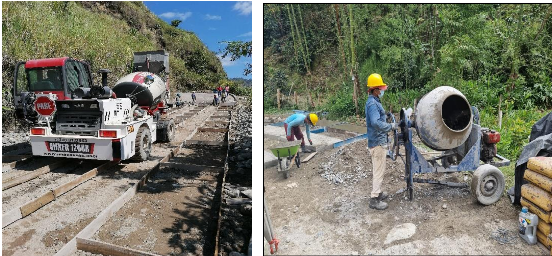
Figura 19: Mezcladora de Concreto insitu: Izquierda: Placa-huella Mesa de Togoima, Derecha: Placa-huella El Carmen. Páez, Cauca.
