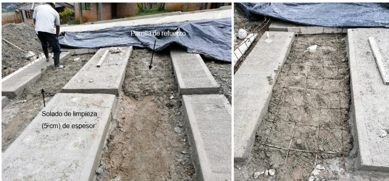
Figura 31: Instalación de la parrilla de acero para las placas-huella. Reasentamiento de Avirama.
