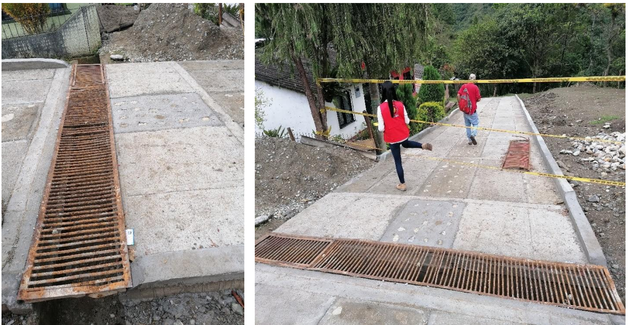
Figura 43: Sumidero Transversal Placa-huella Reasentamiento del Minuto de Dios, Páez, Cauca.
