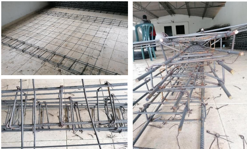
Figura 25: Zona de Corte y Figurado del acero. Reasentamiento de Minuto de Dios, Páez Cauca.
