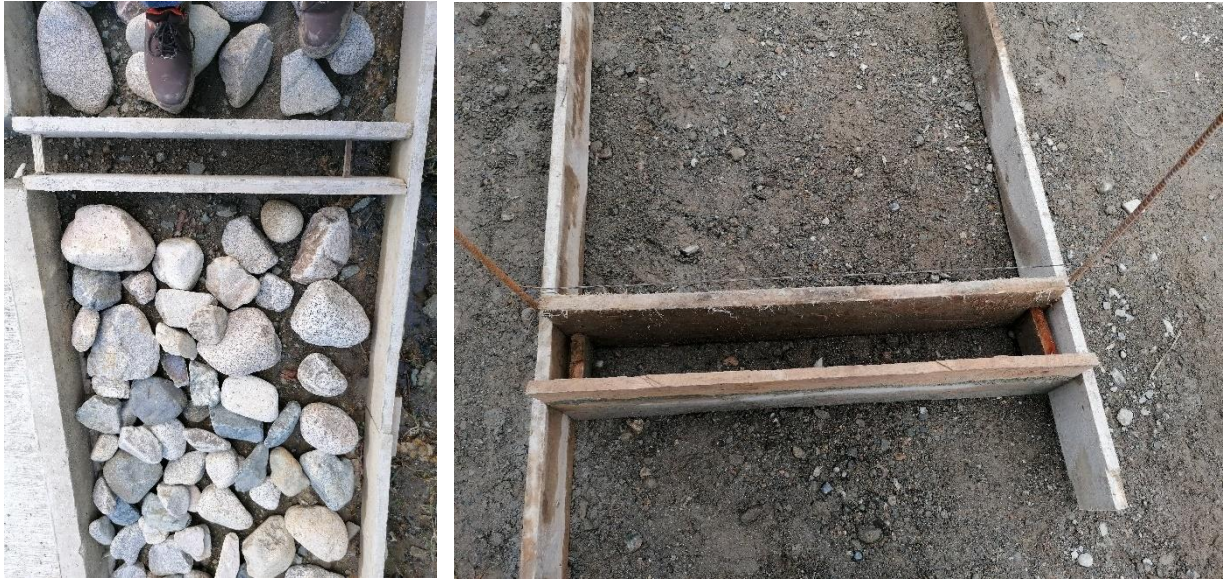
Figura 18: Instalación de Formaleta en madera – Separación para riostra. Izquierda: Placa-huella Mesa de Belalcázar, Derecha: vía de acceso Reasentamiento Las Delicias. Páez-Cauca.
