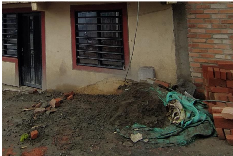
Figura 35. Almacenamiento deficiente de materiales. Obra No. 9
