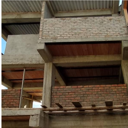
Figura 74. Detalle muros sin amarrar. Obra No.2
