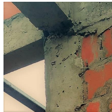
Figura 70. Detalle hormiguero en obra No. 13
