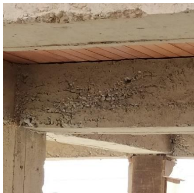
Figura 68. Detalle hormiguero en obra No. 2
