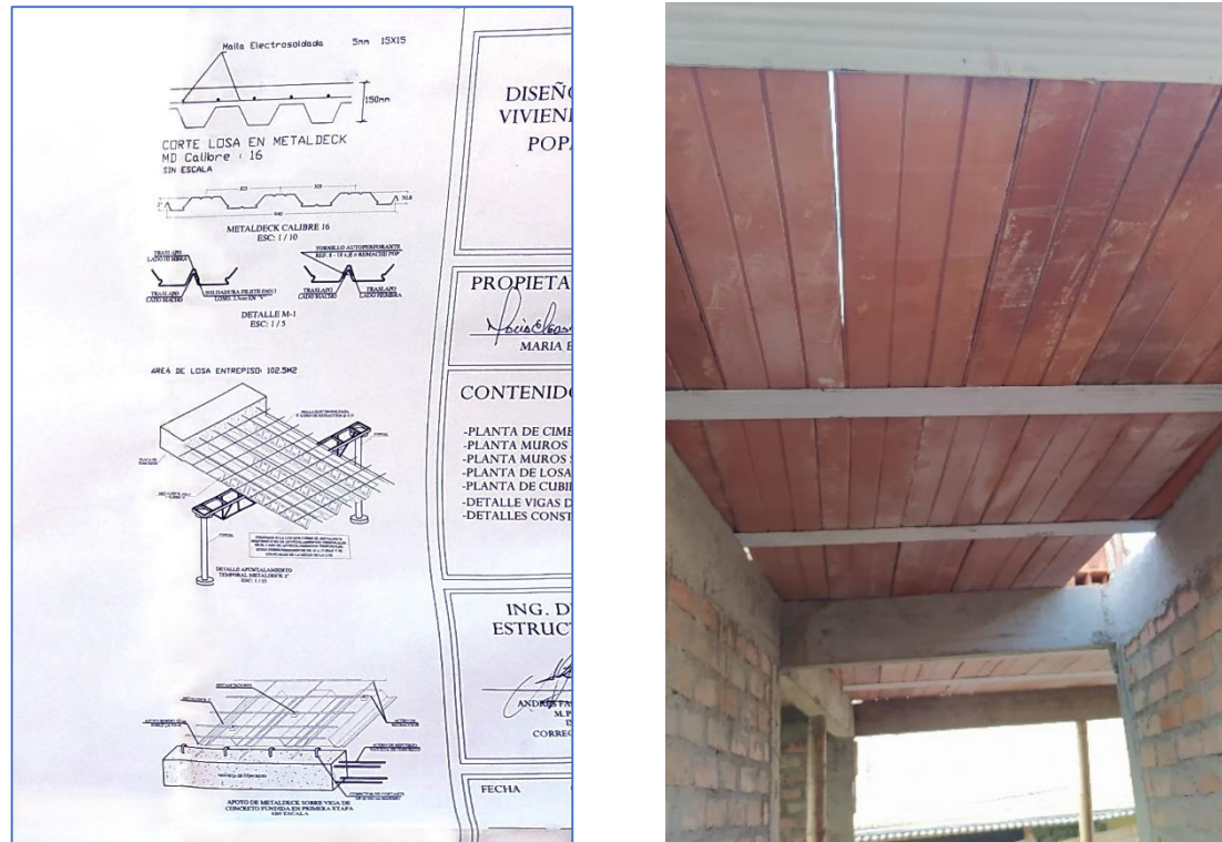
Figura 13. Comparación de losa aprobada en planos vs constuida. Obra No. 3
