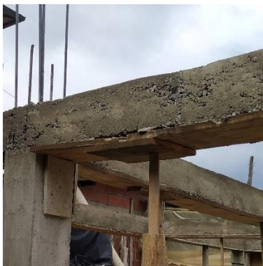
Figura 69. Detalle hormiguero en obra No. 4
