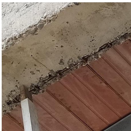
Figura 71. Detalle Acero expuesto en obra No. 2
