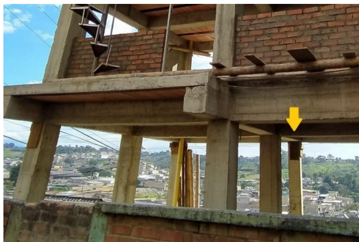
Figura 10. Ubicación de columna con sección reducida. Obra No. 2
