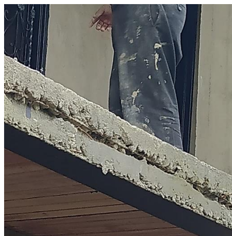
Figura 72. Detalle Acero expuesto en obra No. 10
