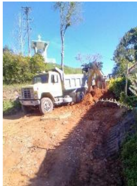
Imagen 23. Retiro de tierra de la explanación con la retroexcavadora y cargue en volqueta. Barrio La Capilla.
