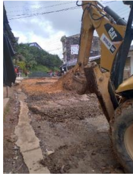
Imagen 86. Excavación de la explanación para el empalme con pavimento existente. Barrio Obrero
