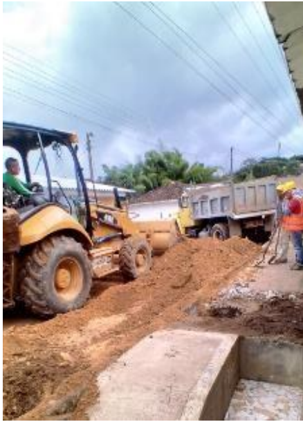
Imagen 110. Retiro de tierra proveniente de la excavación de la explanación de la vía. Barrio Patio Bonito.
