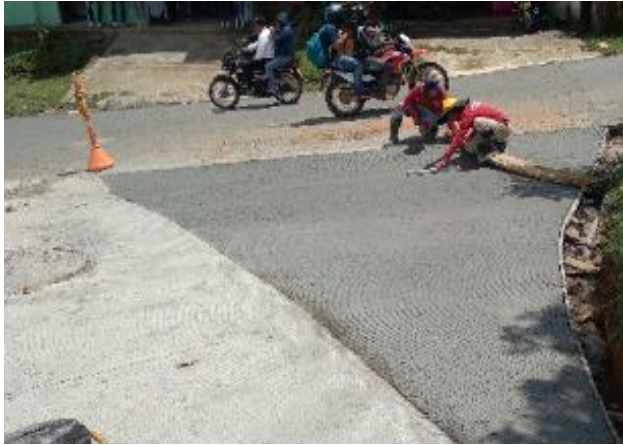
Imagen 48. Tallado y acabados para estado final de la vía. Barrio La Capilla.
