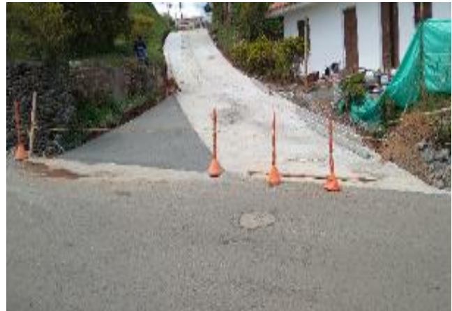
Imagen 47. Estado final de la vía pavimentada en concreto rígido. Barrio La Capilla.
