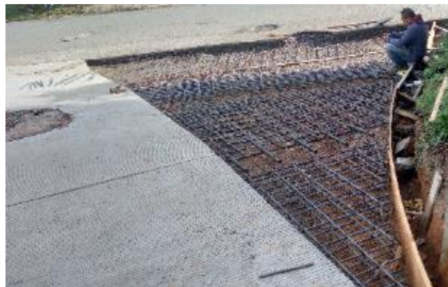
Imagen 34. Ampliación de la vía con parrillas dobles por cada placa con varillas de 1/2". Barrio La Capilla.
