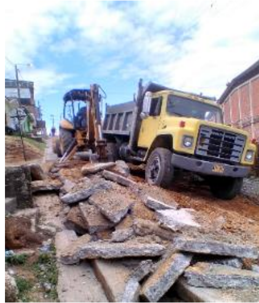
Imagen 153. Retiro de escombros con la retroexcavadora y cargue en volqueta. Sector Galería.
