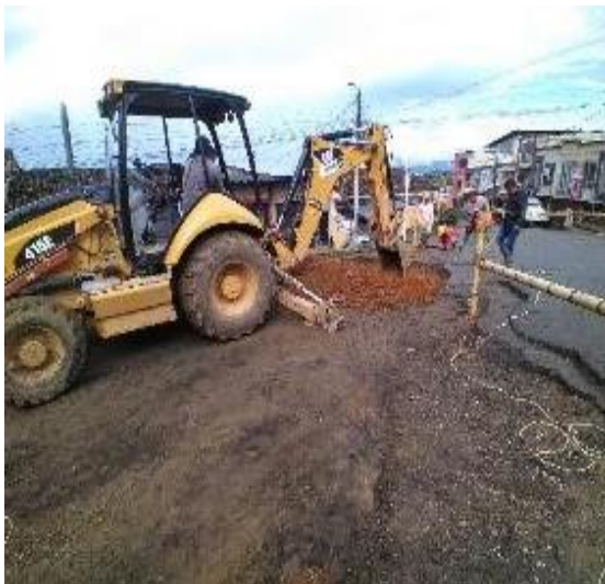
Imagen 89. Excavación de la explanación para el empalme de la calzada con la vía principal. Barrio Obrero.
