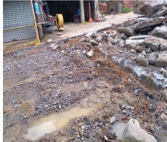
Imagen 50. Daño en las redes de agua potable por estar muy expuestas. Barrio Obrero.
