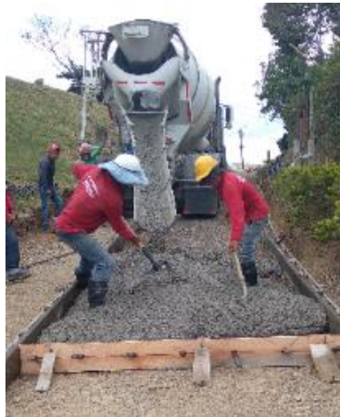
Imagen 38. Fundición del primer carril en concreto rígido con el mixer. Barrio La Capilla.
