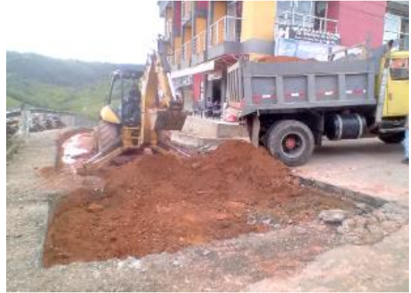
Imagen 156. Excavación del empalme para adecuación de subrasante y la respectiva conformación de subbase. Sector Galería.
