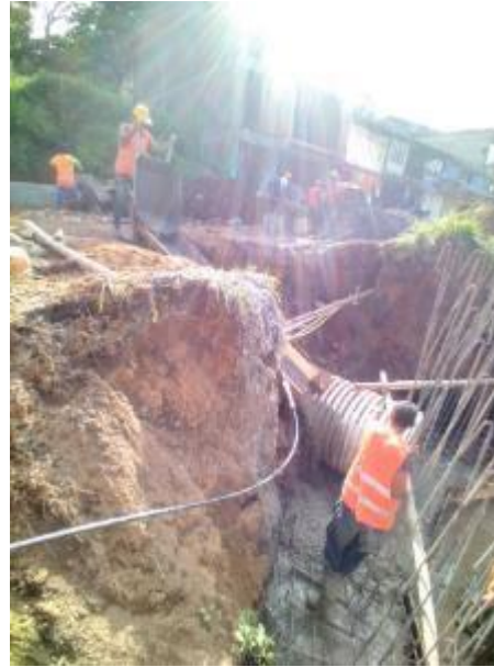
Imagen 68. Fundición de la base de las aletas para la alcantarilla. Barrio Obrero.
