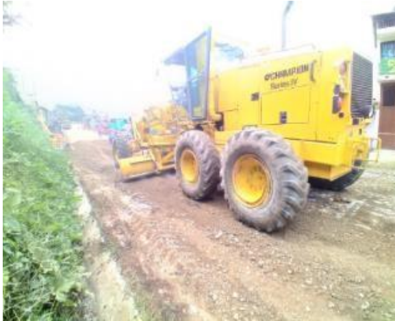
Imagen 94. Continuación de riego y conformación de la subbase con la motoniveladora en el tramo faltante. Barrio Obrero.
