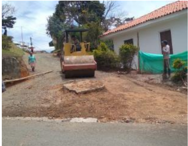
Imagen 29. Compactación final de la subbase luego del retiro de material contaminante. Barrio La Capilla.
