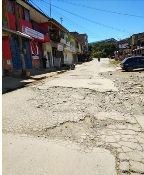
Imagen 7.Estado inicial, Barrio Obrero.
