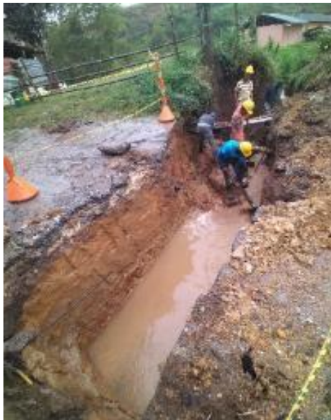
Imagen 16. Empozamiento de agua en la zanja por causa de las lluvias. Barrio La Playa.
