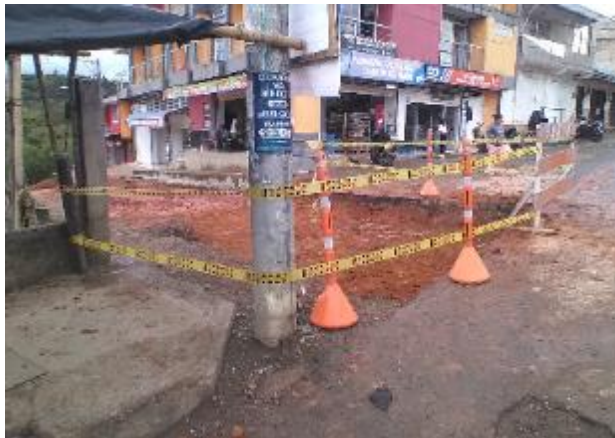
Imagen 159. Inicio de actividades de excavación por parte del personal del acueducto. Sector Galería.
