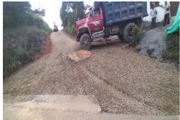
Imagen 26. Riego y conformación de la subbase para el empalme de la calzada con la vía principal. Barrio La Capilla.
