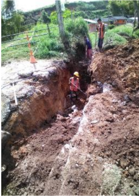
Imagen 14. Excavación para la reposición de la alcantarilla a intervenir. Barrio La Playa.
