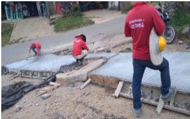
Imagen 46. Estado final de las placas del primer carril fundidas hasta el empalme. Barrio La Capilla.
