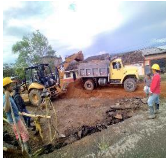
Imagen 88. Retiro de tierra proveniente de la excavación para el empalme. Barrio Obrero.
