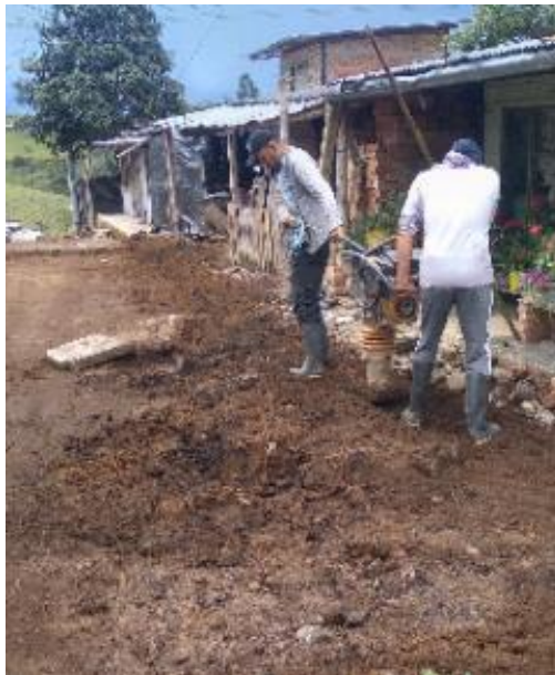
Imagen 151. Relleno y compactación de la excavación por parte del personal del acueducto. Barrio Villa del Sol.
