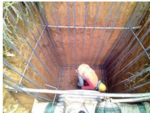
Imagen 57. Armado de parrilla con acero de refuerzo para cabezal de alcantarilla. Barrio Obrero.
