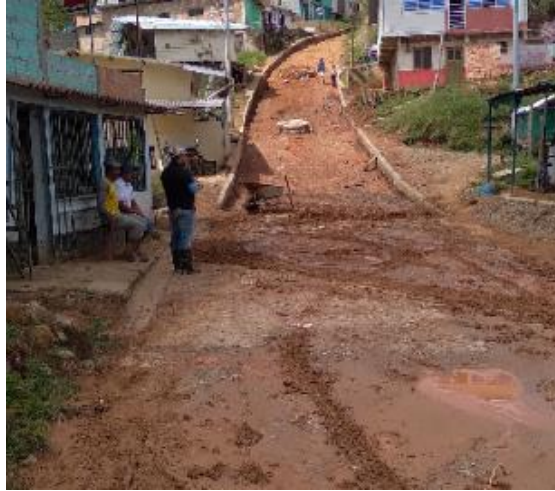
Imagen 164. Retiro manual de la tierra saturada debido a las lluvias. Sector Galería.
