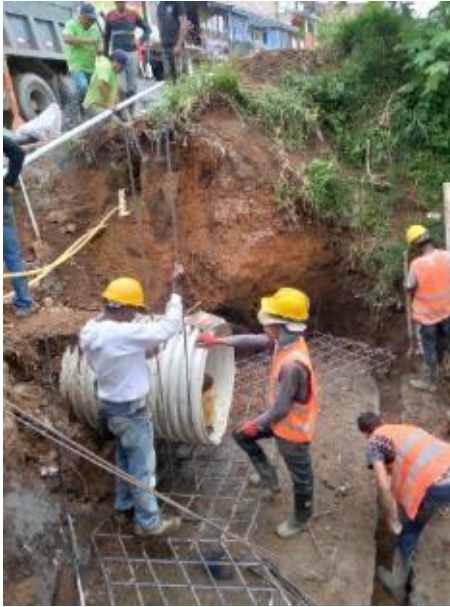
Imagen 69. Armado de acero de refuerzo para base de las aletas de la alcantarilla. Barrio Obrero.
