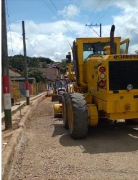
Imagen 124. Continuación de conformación de la subbase con la motoniveladora. Barrio Patio Bonito.
