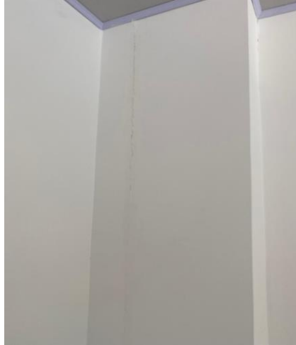
Figura 52: Fisura en closet (Antes)
