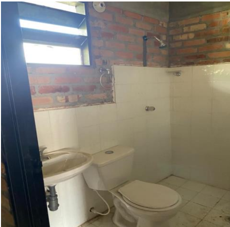
Figura 24: batería sanitaria, enchapados, ducha
