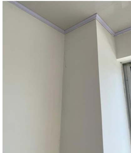
Figura 54: fisuras de columnas (Antes)
