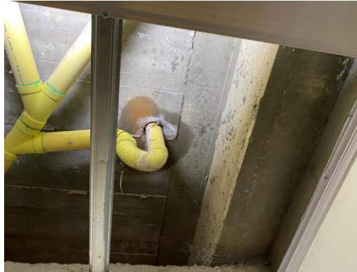
Figura 38: visible filtración por emboquillado deficiente
