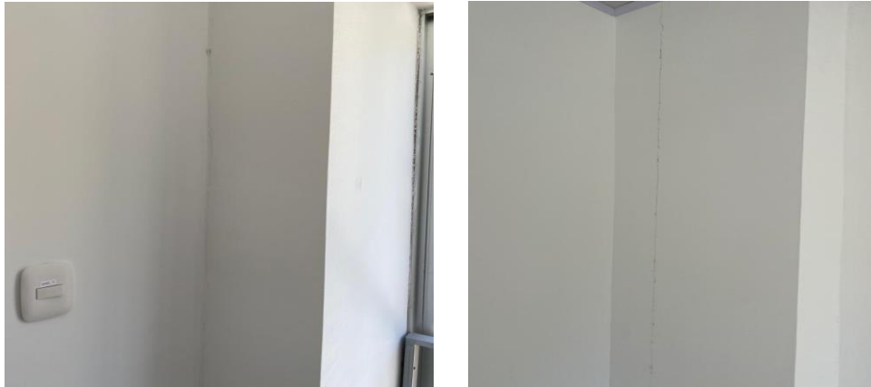
Figura 41, Figura 42: Fisuras entre columna y pared y en pared de closet
