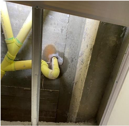
Figura 50: Daño en cielo falso por mal emboquillado (Antes)
