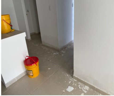
Figura 34: Vista apto 102 con humedad en paredes De cocina, patio, pasillo entrada
