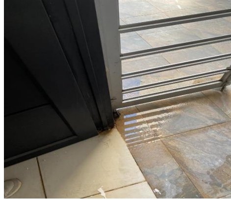
Figura 35: Vista de entrada apto 101 y puerta ppal con ingreso de agua exterior
