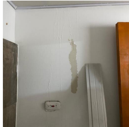
Figura 49: afectación por filtración baño apto 203(antes)
