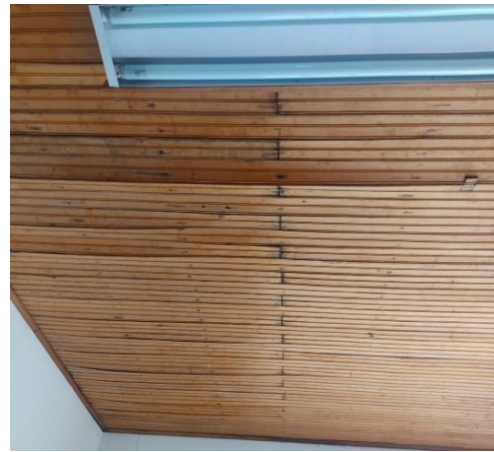
Figura 88: Desprendimiento de Cielo raso
