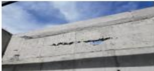
Figura 9. Antes - Después (Oquedades.)
