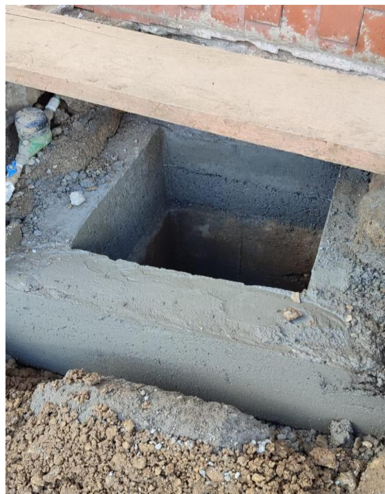
Ilustración 21. Caja de Inspección. Tomada in situ.
