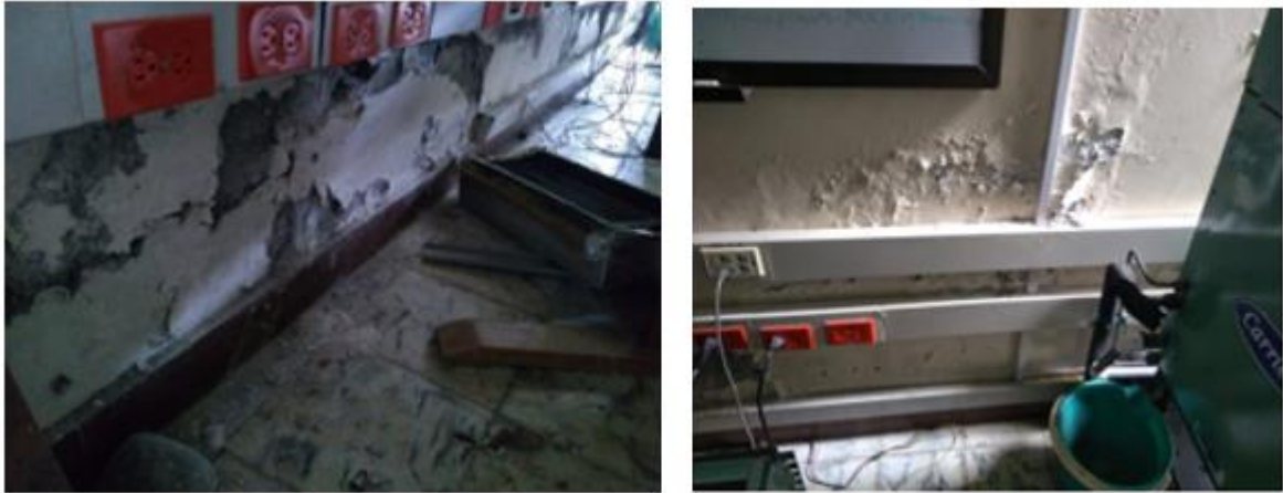
Ilustración 25 Evidencia de salón de servidores 33
