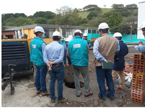
Ilustración 44 Identificación de alcantarillado
