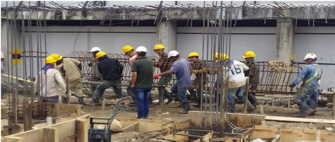
Imagen 41: Debido al avance de la obra los trabajadores realizaron la ubicación del castillo, lo cual aprecie que es un método inseguro debido a que pueden ser arrastrados en el momento ubicarlo.
