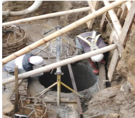
Imagen 23: Se dificulta la construcción del #122 por el NF alto y la estabilidad del talud h=5.83m a nivel de sótano.
