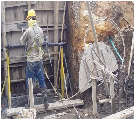
Imagen 22: Nivel freático alto, a la derecha se observa uno de los cuatro nacimientos localizados en diferentes partes del talud.
