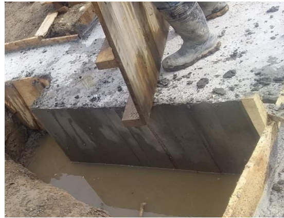
Imagen 73: Desencofrado, sin hormigueros.
