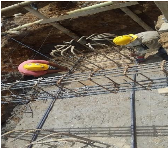
Imagen 52: Una vez se revisa el nivel del Solado de limpieza se inicia a construir el cabezal, el cual cubre totalmente los caisson.
