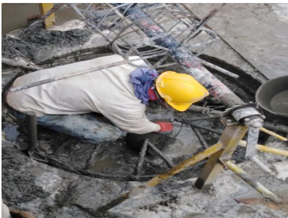
Imagen 46: Debido al Nivel freático alto se inunda rápidamente.
