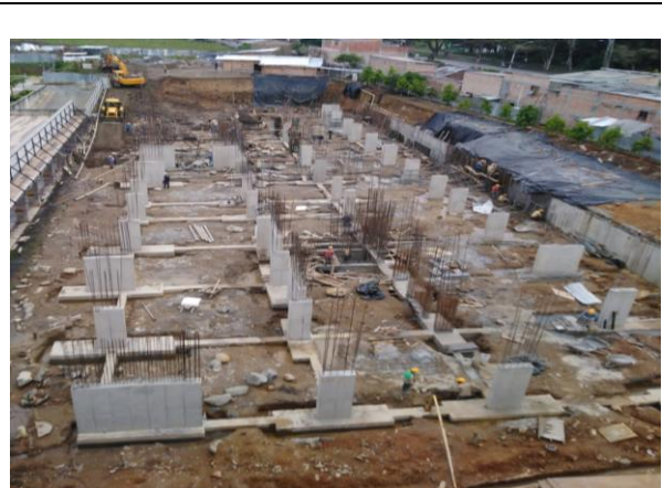
Imagen 2: N+/-0.0m, Nivel del sótano, parqueaderos, quedan fundidos columnas, pantallas y vigas de cimentación, mejoramiento de suelo.
