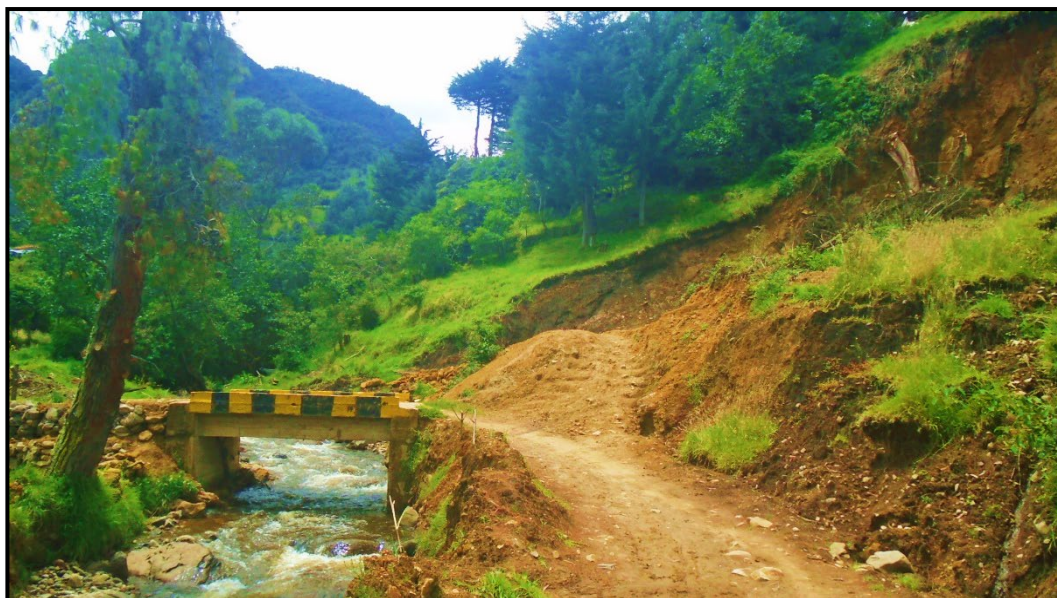
Imagen 4: Puente afectado por deslizamiento tipo planchado, sector Hache. Fuente: Fotografía tomada durante el trabajo de campo, 2023.
