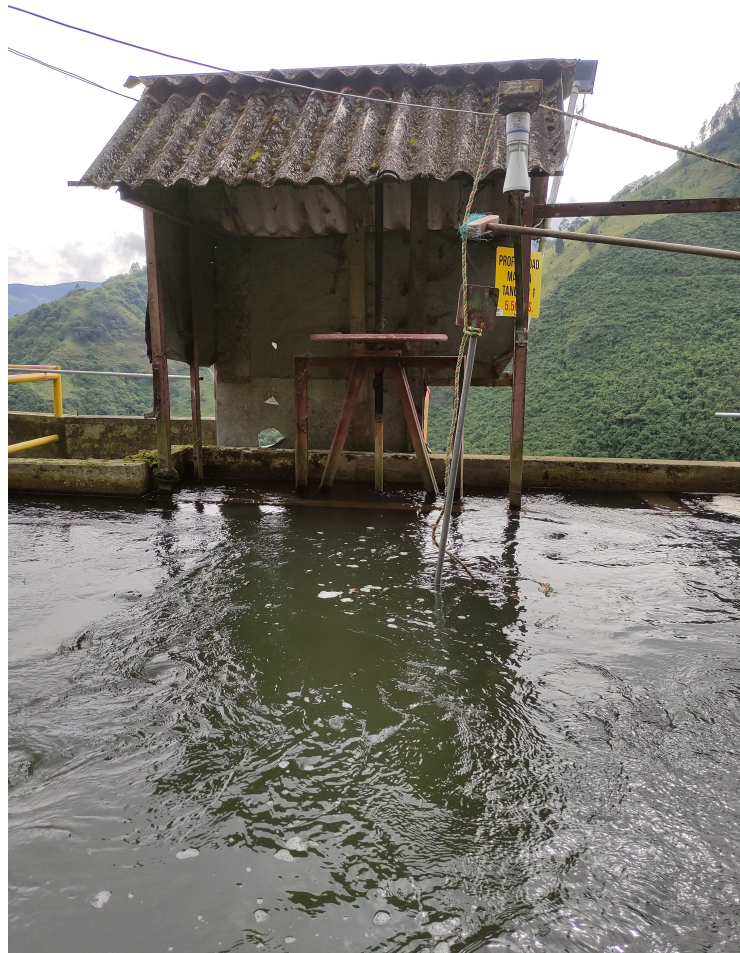
Figura 4.14: Sensor instalado en tanque de carga Elaboración propia.
