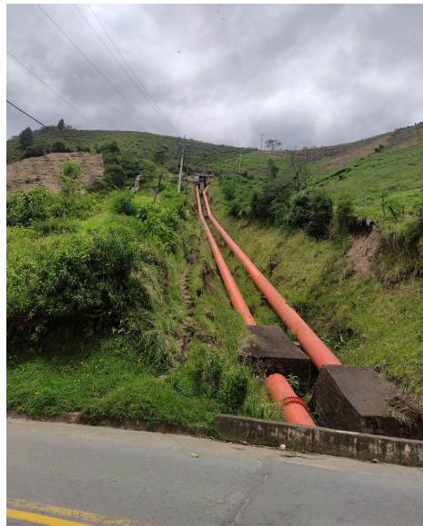
Figura 4.3: Tuberías Elaboración propia.
