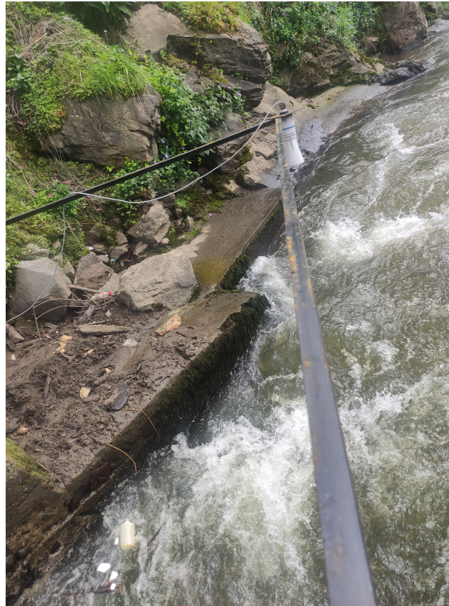
Figura 4.13: Sensor instalado en bocatoma Elaboración propia.
