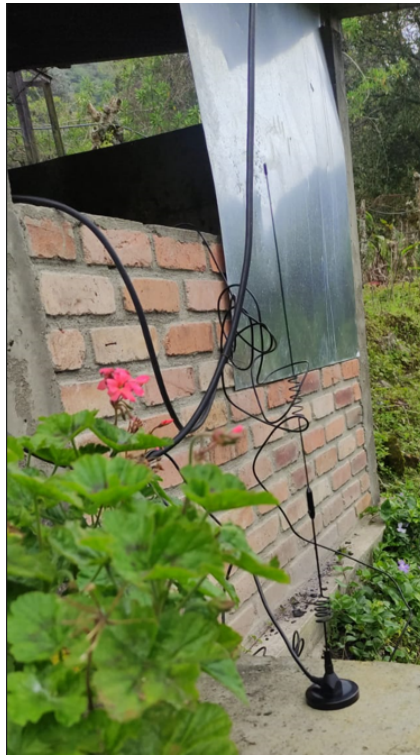
Figura 3.11: Antena instalada en la bocatomá Elaboración propia.
