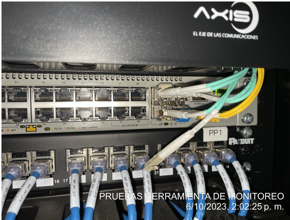
Figura 4.3: Desconexión física del switch de acceso. Fuente: Elaboración propia.
