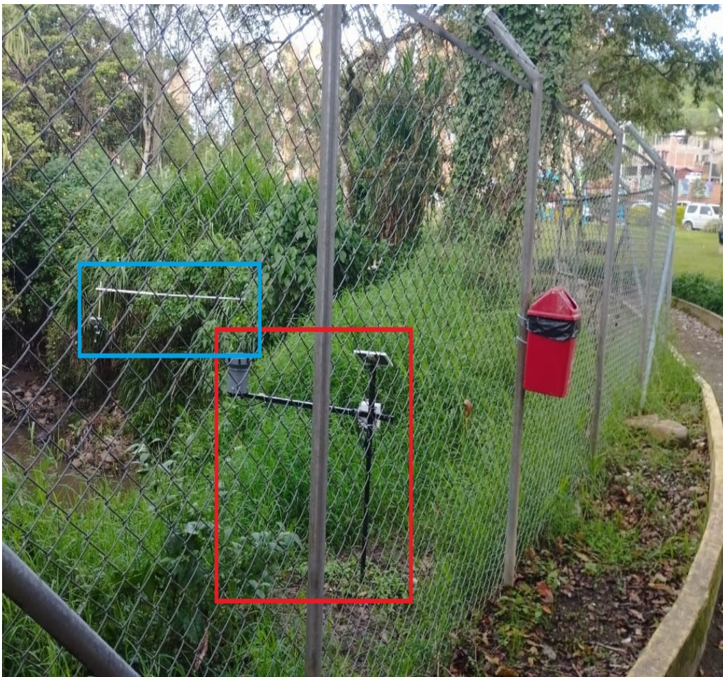
Figura E.1: Instalación de la estación de pluviometría. Fuente: Elaboración propia.
