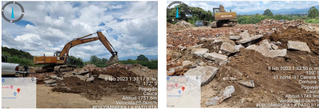
Ilustración 8. Material RCD – Escombrera
