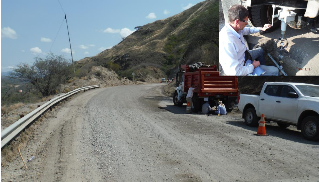
Grafica No 17. Sector donde se desarrollaron las pruebas de resistencia, PR 94+0990, Vista Sur - Norte
