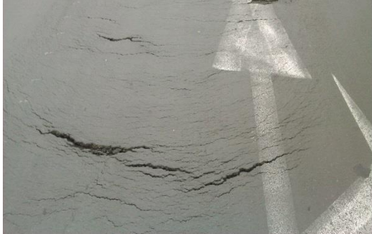
Fotografía 1. Fisuración por deslizamiento de capas. Fuente: Esta investigación.
