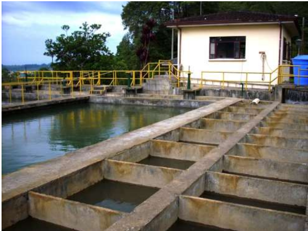
Vista general, Planta Tratamiento Tulcán.
