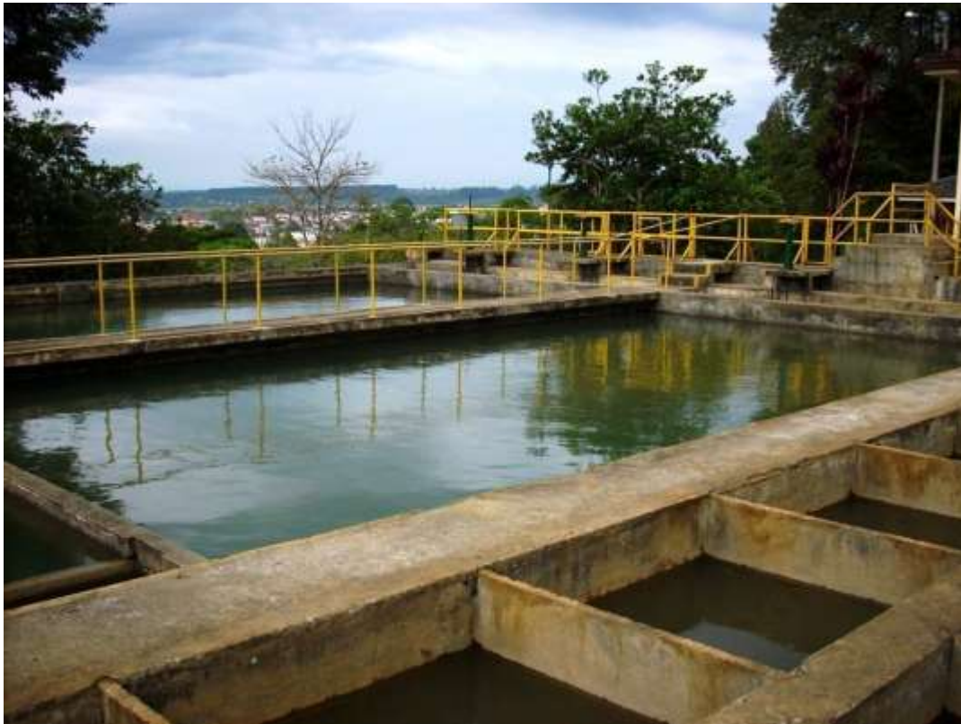
Vista general, Planta Tratamiento Tulcán.
