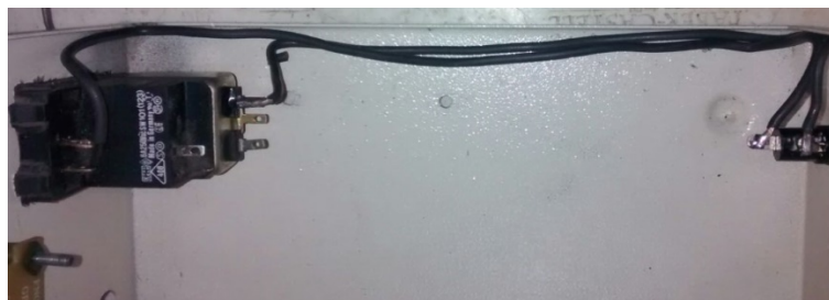
Figura 4.31: Conexión entre el fusible y el filtro EMC. Fuente: Elaboración Propia
