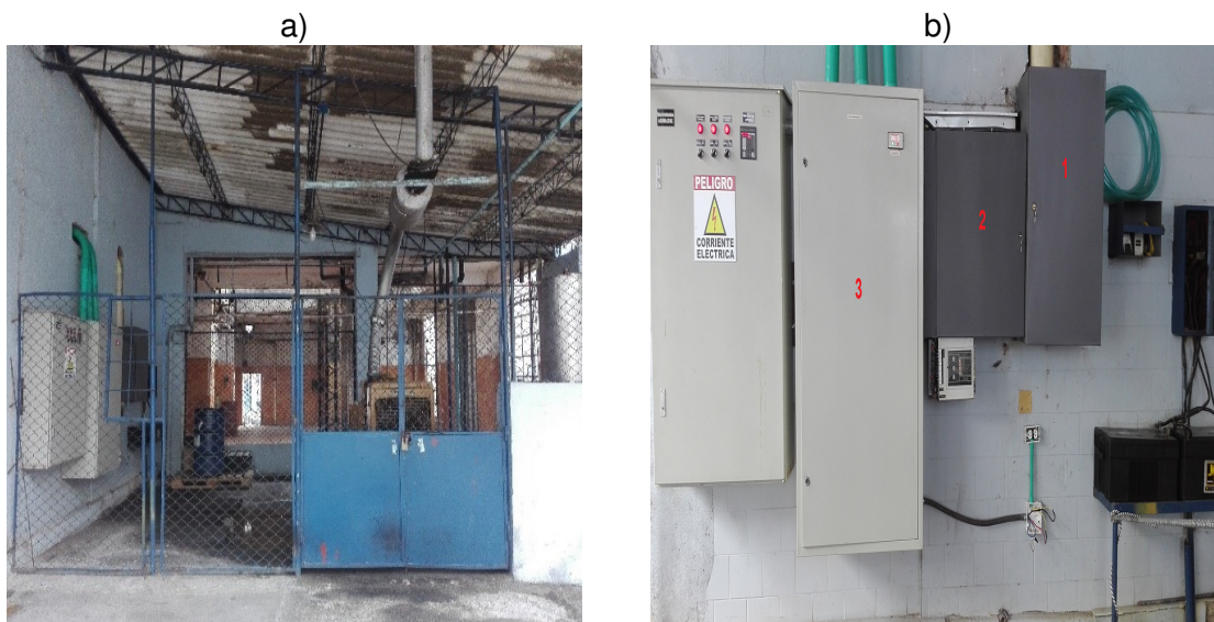
Ilustración 4.24: a) Cuarto de distribución b) Tableros de distribución.
