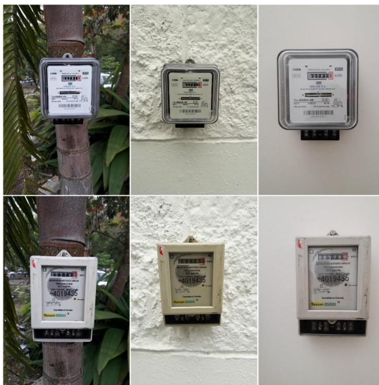
Figura 44. Contadores expuestos a diferentes ambientes lumínicos [Fuente Propia]
