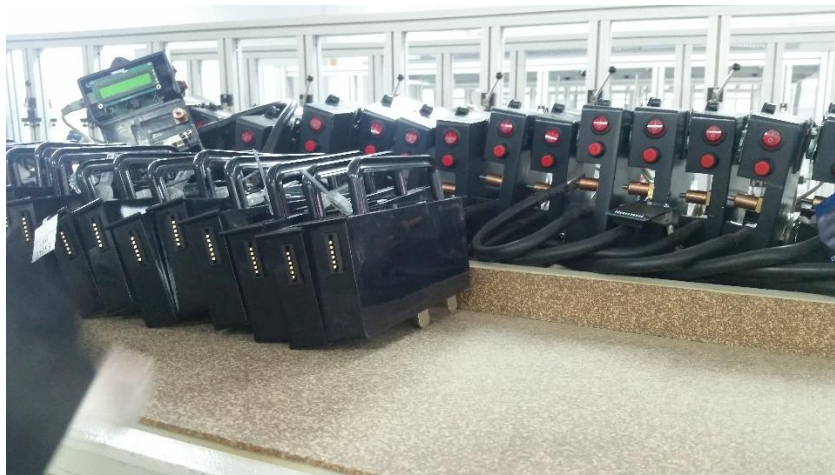
Figura 7. Medidores de teledatificación centralizados – Concentradores de información.
