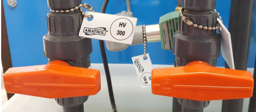
Figura F 4. Válvulas de drenaje para el tanque de proceso.
