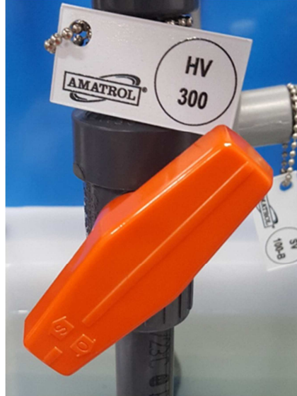
Figura F 35. Válvula manual HV300 con una apertura de aproximadamente el 50%.
