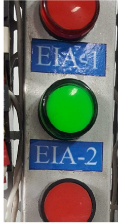
Figura F 11. Bombillo de encendido de planta de presión.
