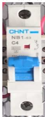
Figura H 5. Breaker de encendido.
