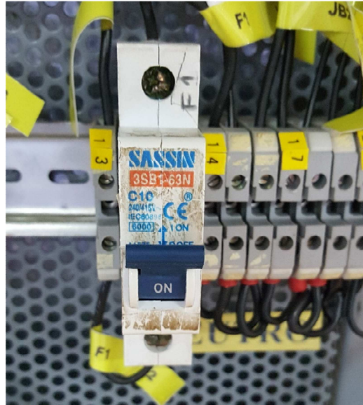
Figura F 8. Breaker de encendido de panel de control en planta de tanques interactivos.
