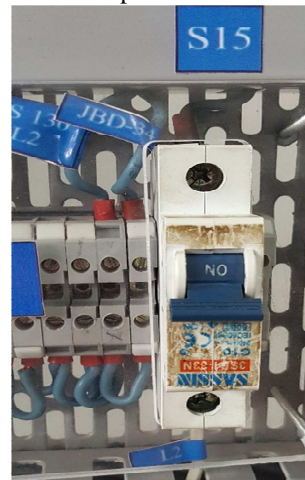
Figura F 10. Breaker de encendido en planta de presión.
