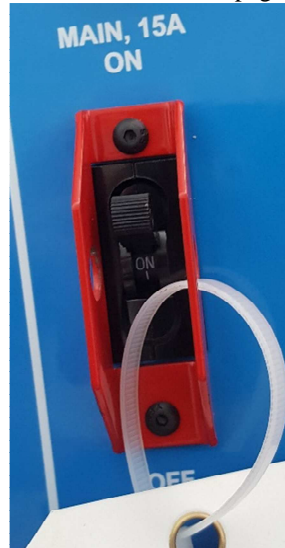
Figura F 1. Breaker de encendido/apagado de la planta.
