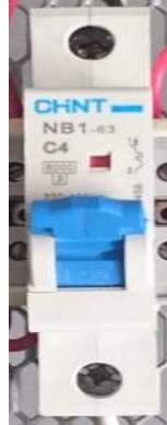
Figura J 4. Breaker de encendido.
