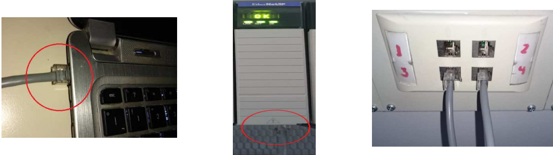
Figura F 47. Conexión Ethernet de los dispositivos a través de cable de red.
