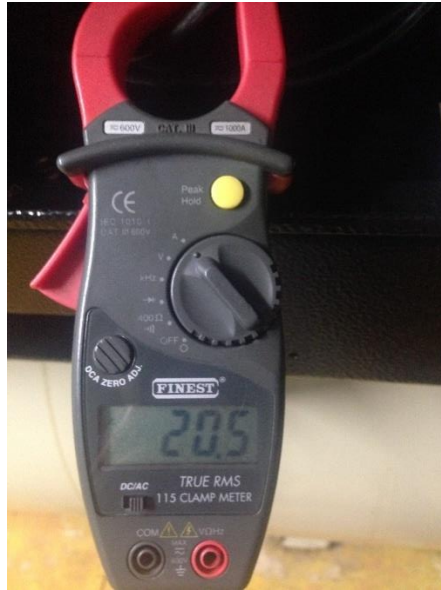
Imagen 13. Consumo corriente compresor en estado normal. Fuente Propia
