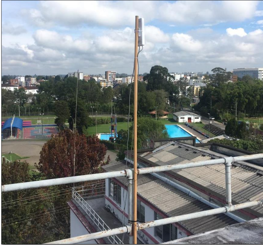
Figura 3.24. Unidad de control instalada.
