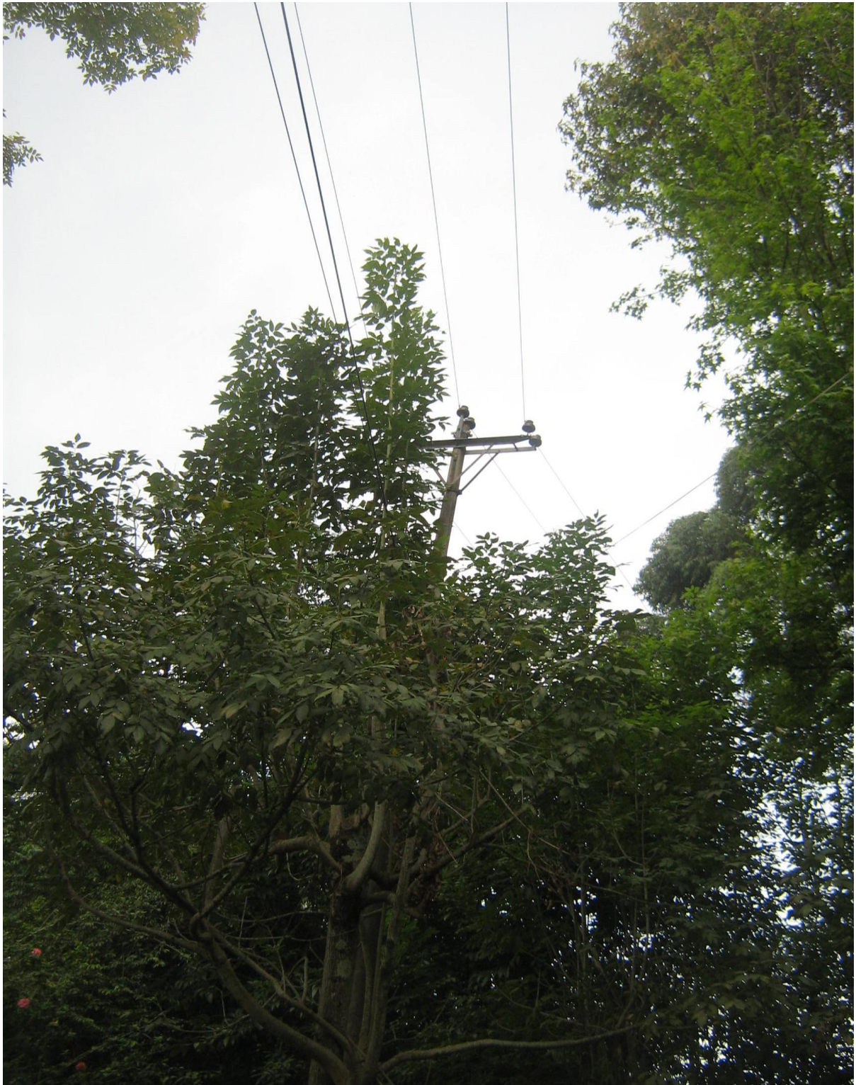
Interferencia de las ramas de los árboles con el cableado de servicios públicos.
