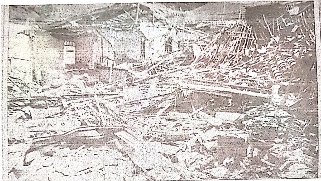
Figura 10. Estructura: alcaldía municipal destruida.
