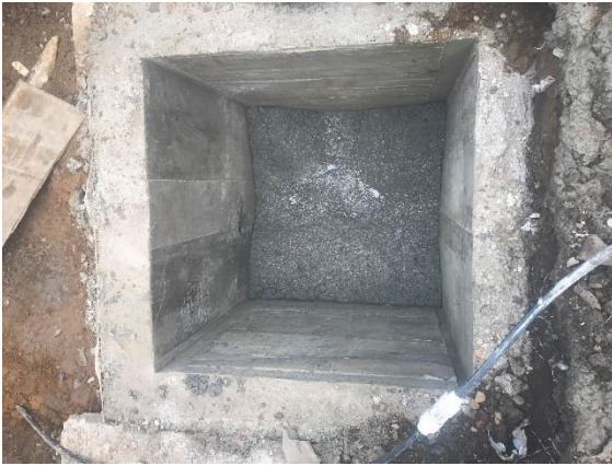
Cajas de distribución en concreto 0.60 m x 0.60 m.
