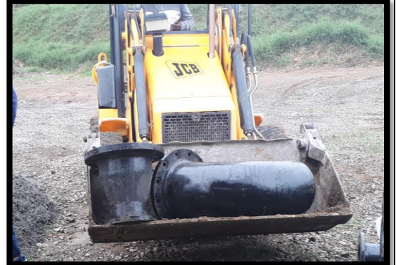
Ilustración 53 Accesorios de empalme tubería de la bomba con la línea de impulsión. Fuente: Propia
