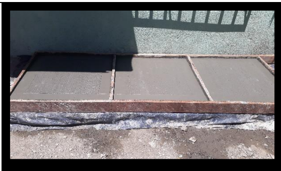
Ilustración 86 Tapas de cajas domiciliarias fundidas del callejón Chará. Fuente: Propia
