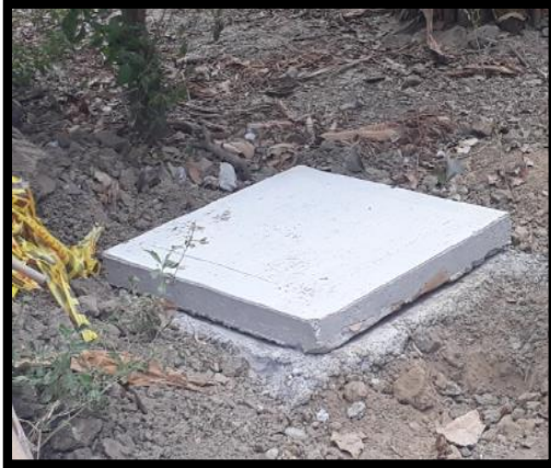
Ilustración 96 Caja domiciliaria del Callejón Palacios terminada. Fuente: Propia
