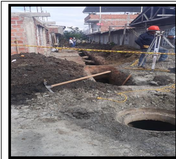
Ilustración 78 Control topográfico para la instalación de la tubería de alcantarillado en el Callejón Chará. Fuente: Propia
