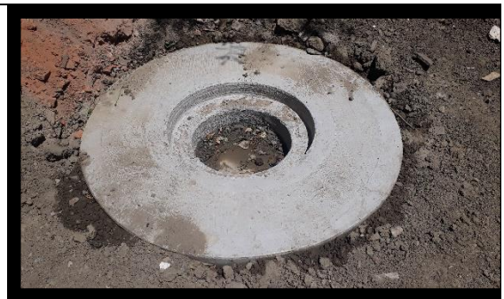
Ilustración 87 Figura 66. Cámara callejón Chará. Fuente: Propia
