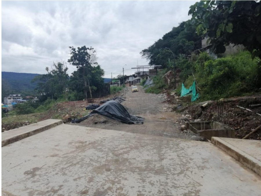
Ilustración 20 "tramo de la vía sin pavimentación"
