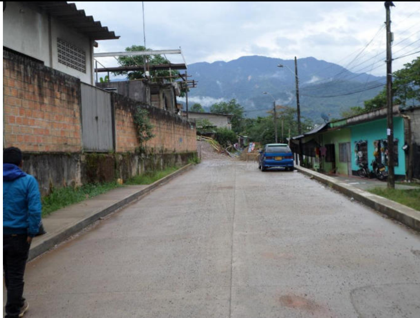
Ilustración 29 "muro de cerramiento que interfiere la continuación del andén" Fuente: propia
