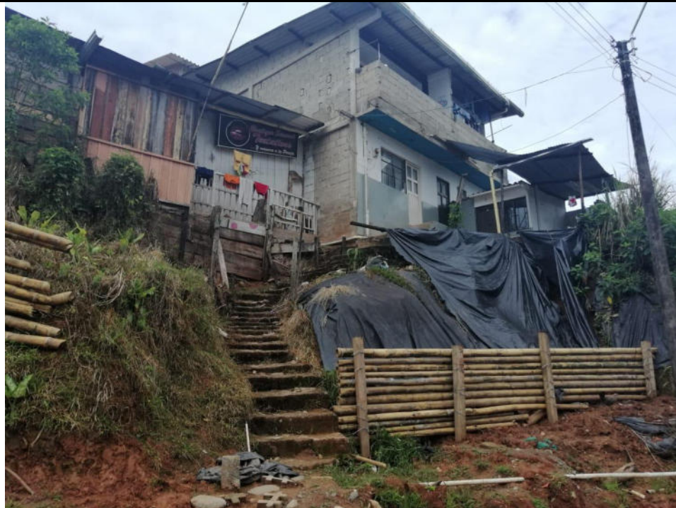
Ilustración 27 "dificultades encontradas en el terreno"
