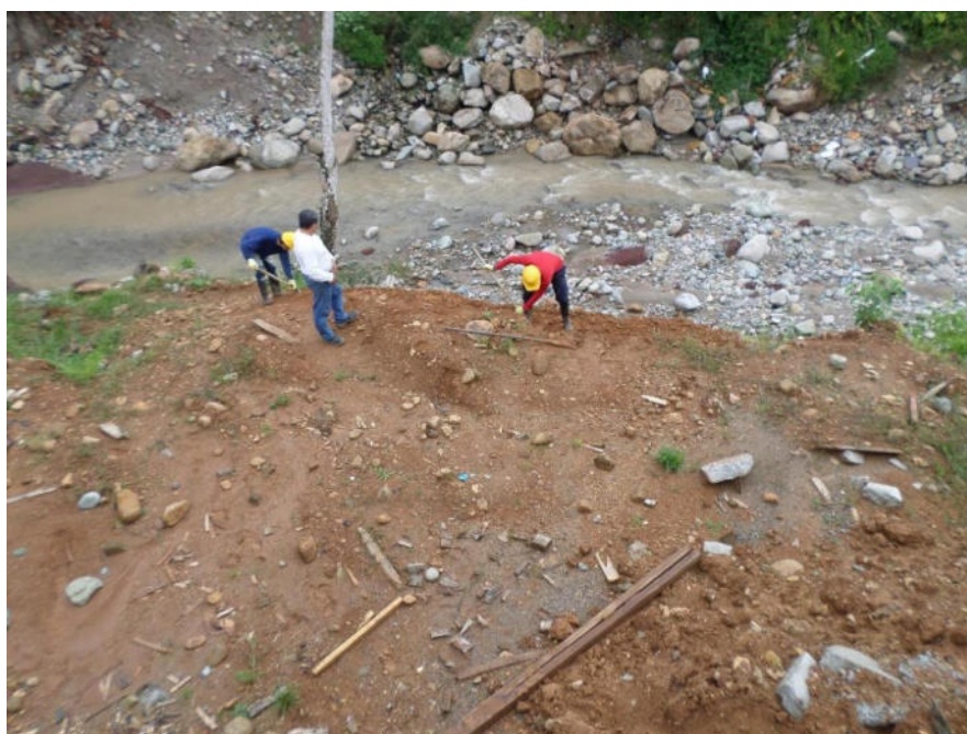
Ilustración 25 "elaboración de la zarpa para el lanzamiento de las vigas el puente" Fuente: propia
