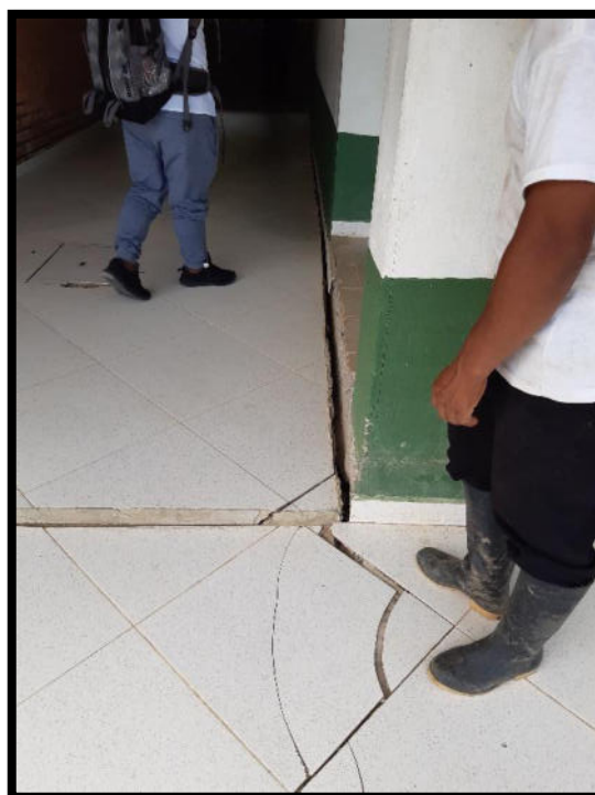
Ilustración 49 "grietas en la estructura que manifiesta la comunidad" Fuente propia
