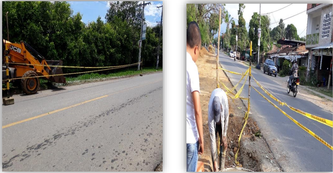
Figura 4. Registro fotográfico de señalización
