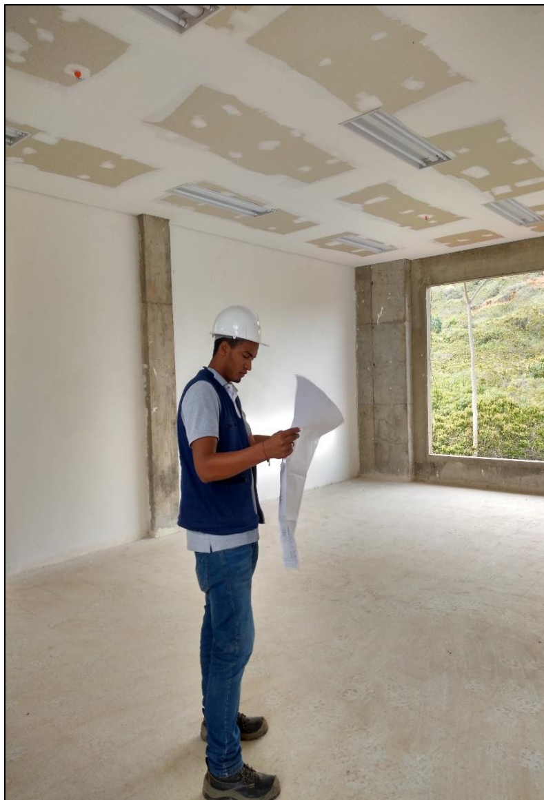
Ilustración 46 Verificación de las lámparas instaladas
