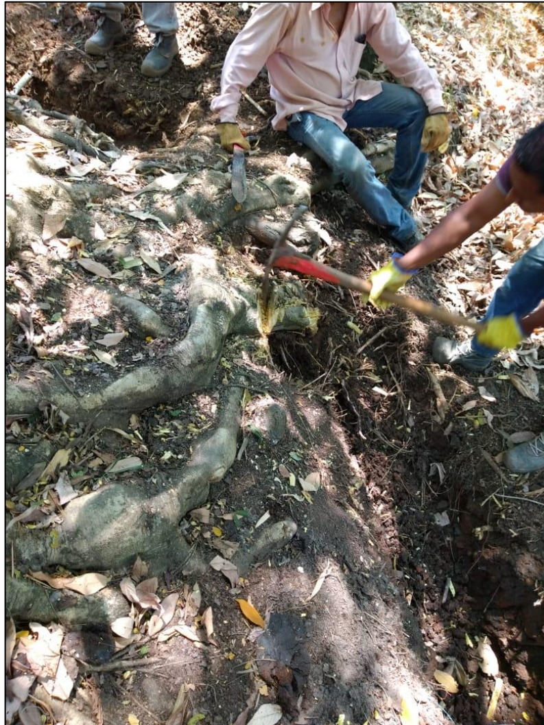
Ilustración 11 Raíces que impiden pasó de la tubería
