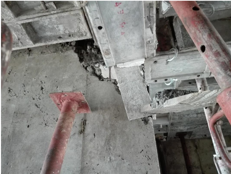
Fotografía 3 Falta de vibrado en muro. Tomada por Jennifer Ospina
