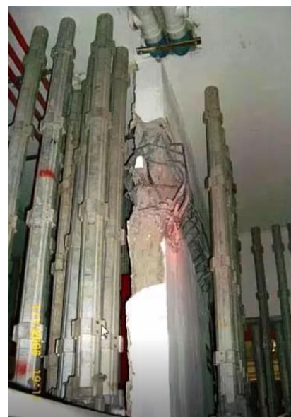
Imagen 12 Falta de confinamiento y longitud menor. Tomada de Scielo.org
