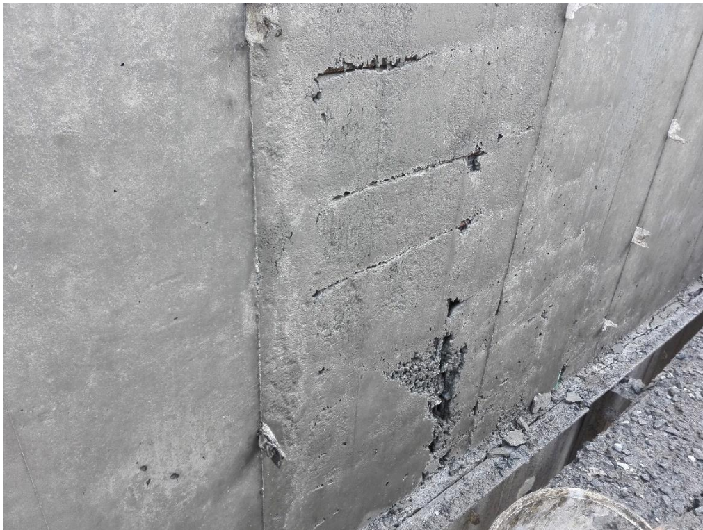
Fotografía 15 Falta de separador de muro, mal vibrado, confinamiento deficiente. Tomada por Jennifer Ospina.
