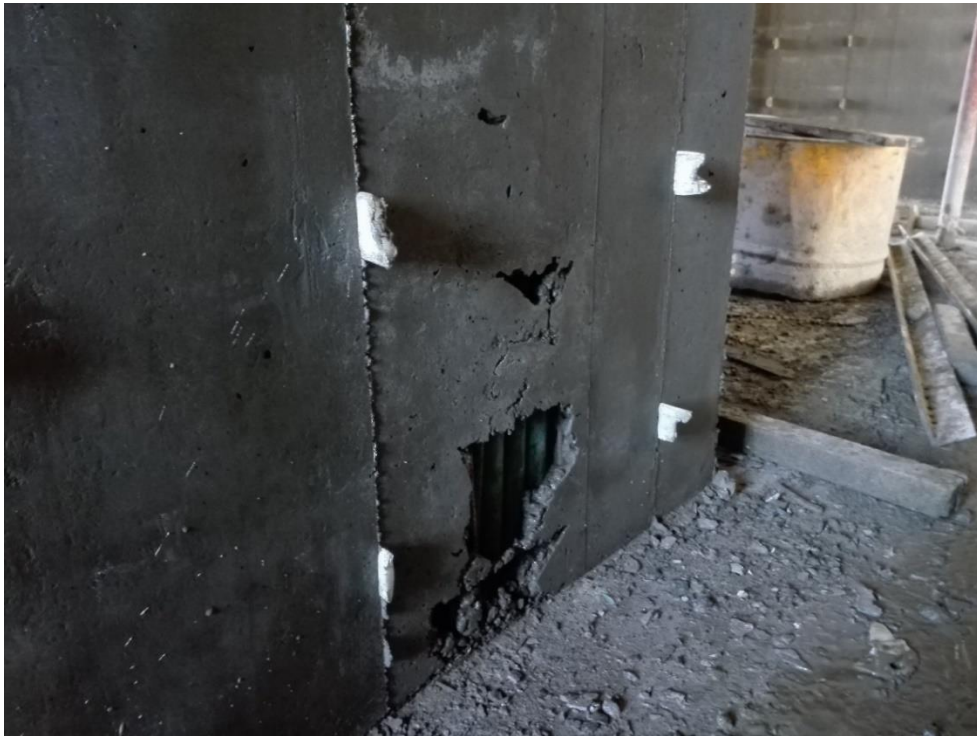
Fotografía 17 Hormigueo producido por tuberías y mal vibrado. Tomada por Jennifer Ospina.
