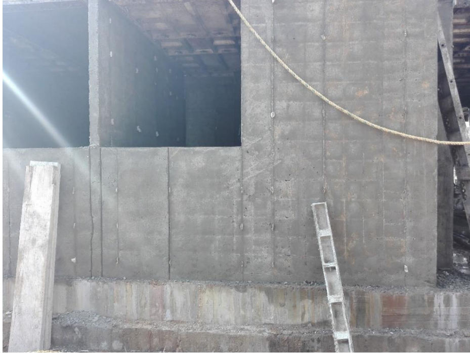
Fotografía 14 Mal confinamiento, falta de separador de muro, malla electrosoldada visible. Tomada por Jennifer Ospina.
