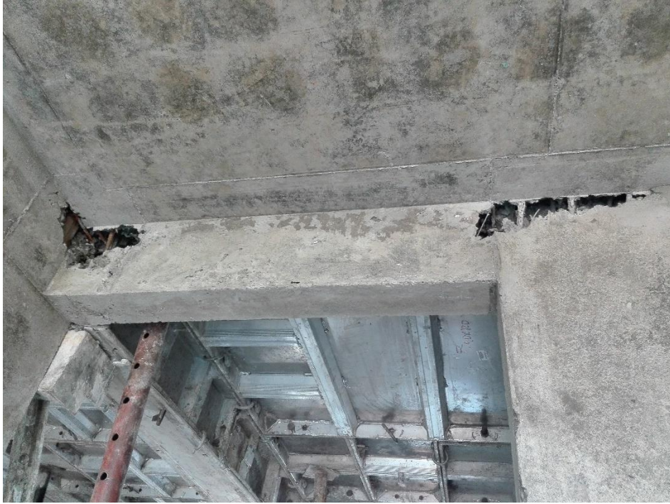
Fotografía 2 Viga afectada por mal vibrado. Tomada por Jennifer Ospina
