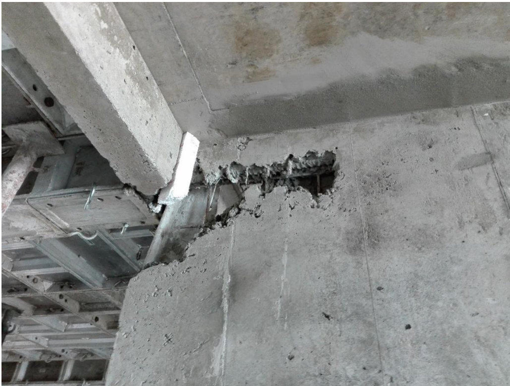
Fotografía 1 Acero de viga expuesto. Tomada por Jennifer Ospina.
