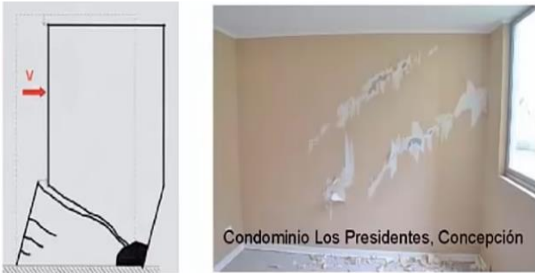
Imagen 9 Falla por corte. Tomadas de www.scielo.org.mx
