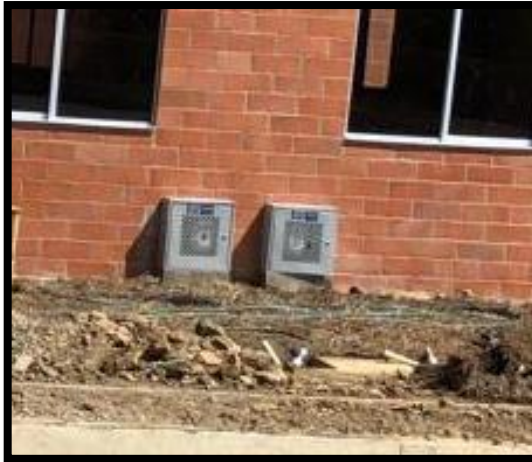
Imagen 16 Fotografía contadores de gas de las viviendas
