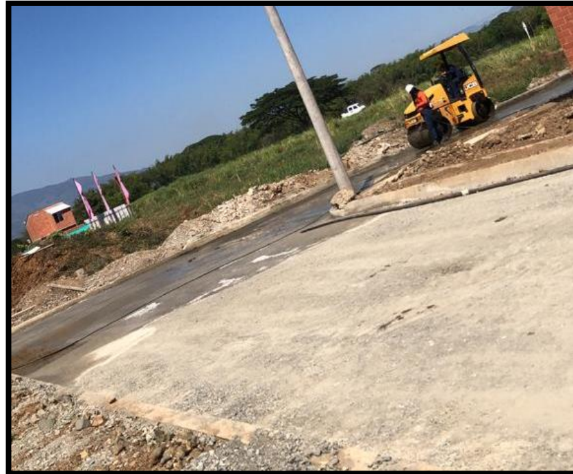
Imagen 9 fotografía estado de las vías urbanización Tucán
