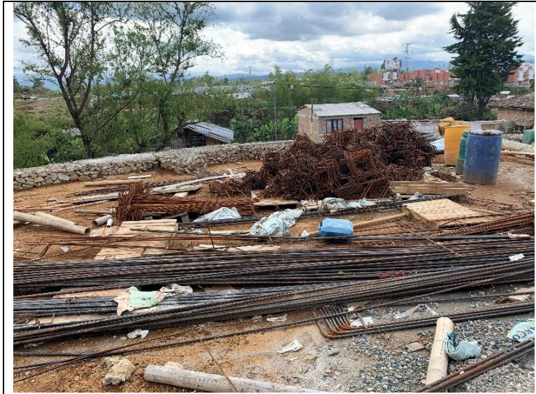
Ilustración 36. Acumulación de acero sobrante Fuente: Propia
