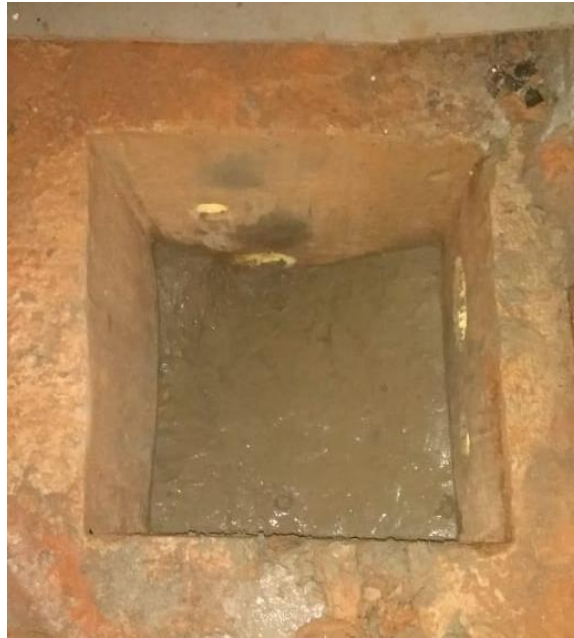
Ilustración 52: Cañuela caja de inspección (70x70) cm, bloque 1. Fuente propia.
