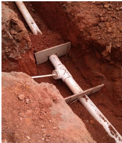
Ilustración 47: Tubería hidráulica con derivación. Fuente propia.
