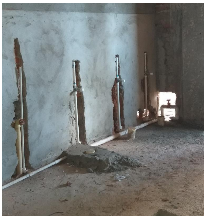
Ilustración 18: Tubería hidráulica para sanitarios y orinales. Fuente propia.
