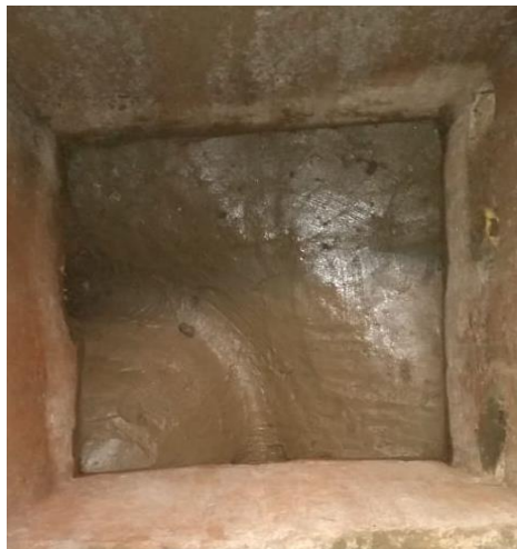
Ilustración 53: Cañuela caja de inspección (70x70) cm, bloque 1. Fuente propia.
