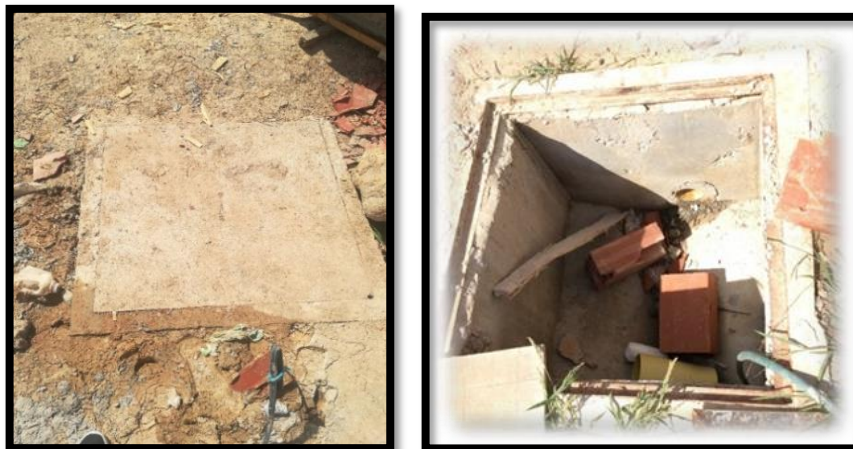
Figura 6 Cajas de inspección sin tapa acumulando residuos.
