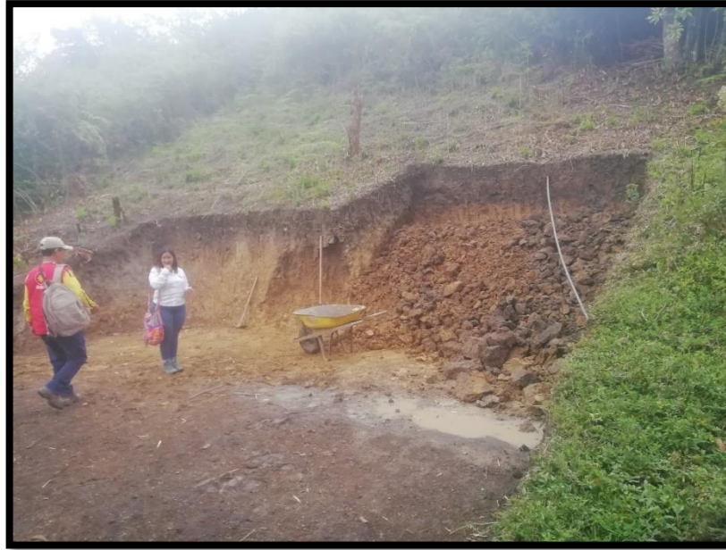
Figura 19 Descapote de vivienda en zona muy inclinada.
