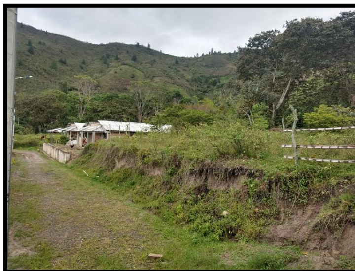
Figura 37 Lote 2 Mesa de Togoima con necesidad de muro de contención.
