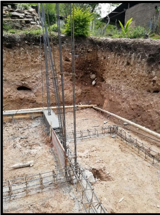
Figura 18 Talud muy inclinado con peligro de inundacion.
