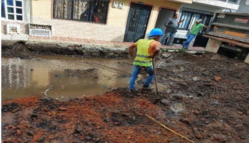
Ilustración 21. Daño manguera de red domiciliaria
