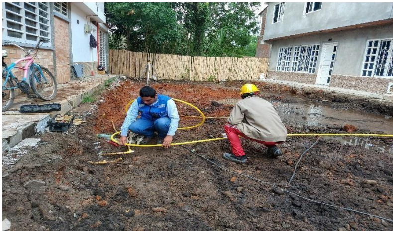
Ilustración 22. Daño manguera de gas
