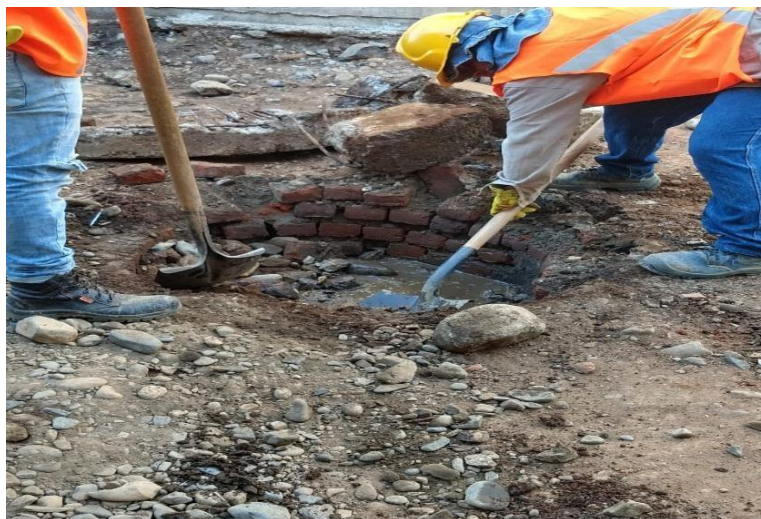
Ilustración 43. Daño de recámara
