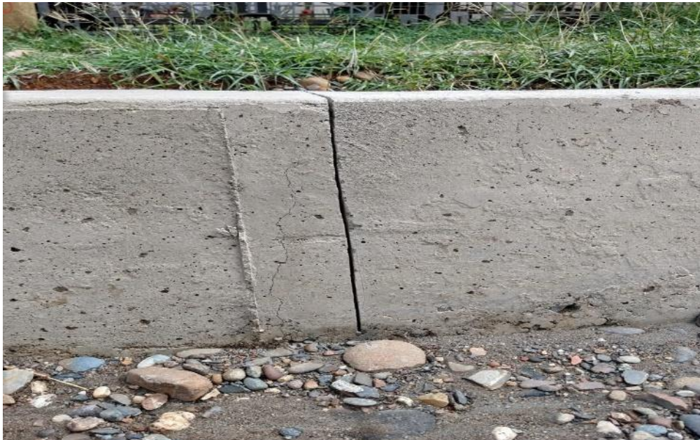
Ilustración 55. Fisuración de sardinel
