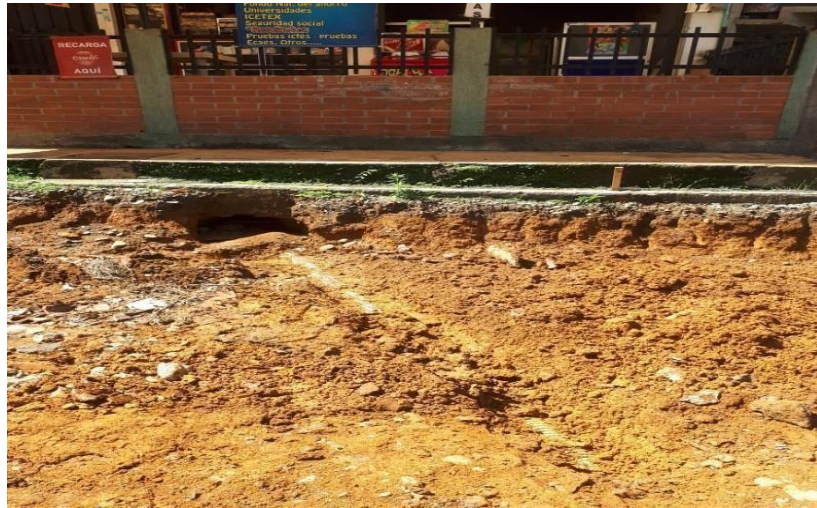
Ilustración 25. Red domiciliaria superficial
