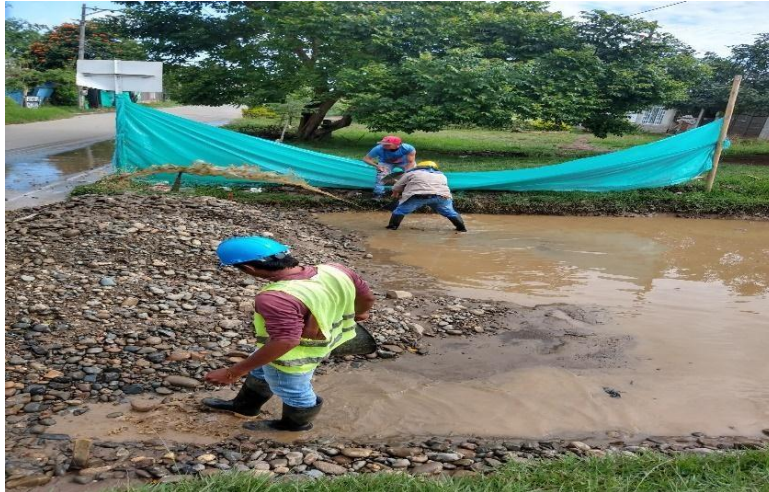
Ilustración 42. Empozamiento por aguas lluvias
