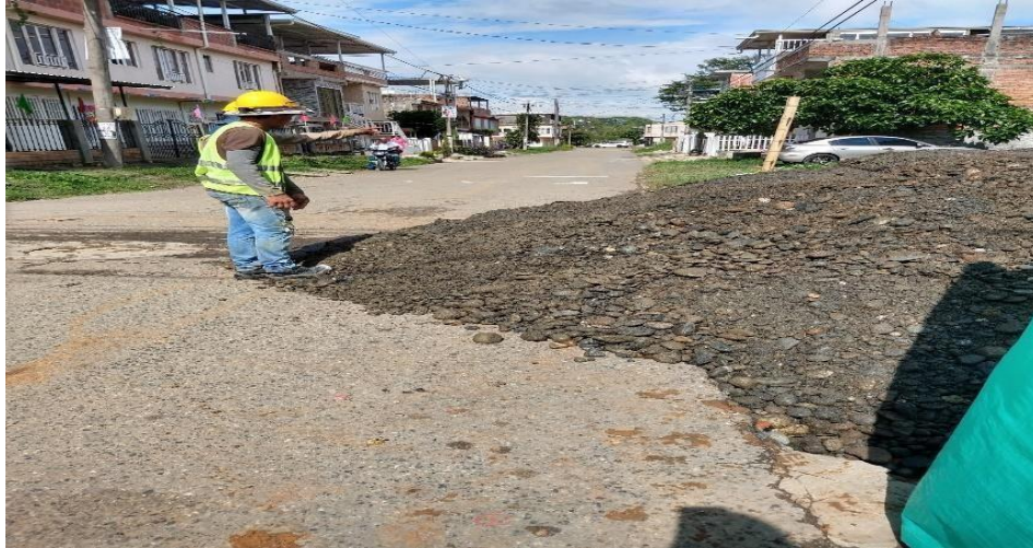
Ilustración 33. Descarga material de forma inadecuada
