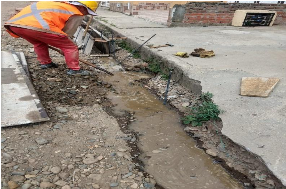
Ilustración 57. Daño con pin
