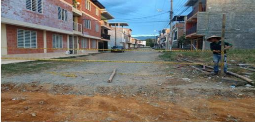
Ilustración 20. Cierre con cinta de peligro
