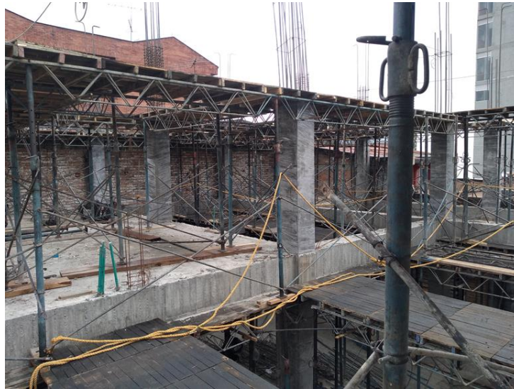
Figura 25. Colocación de camas de soporte donde se ven sus componentes: gatos metálicos, cerchas metálicas, tijeras y tableros.
