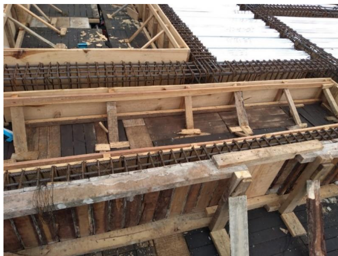
Figura 28. Formaleta en madera con su apuntalamiento en madera y soporte inferior y superior.
