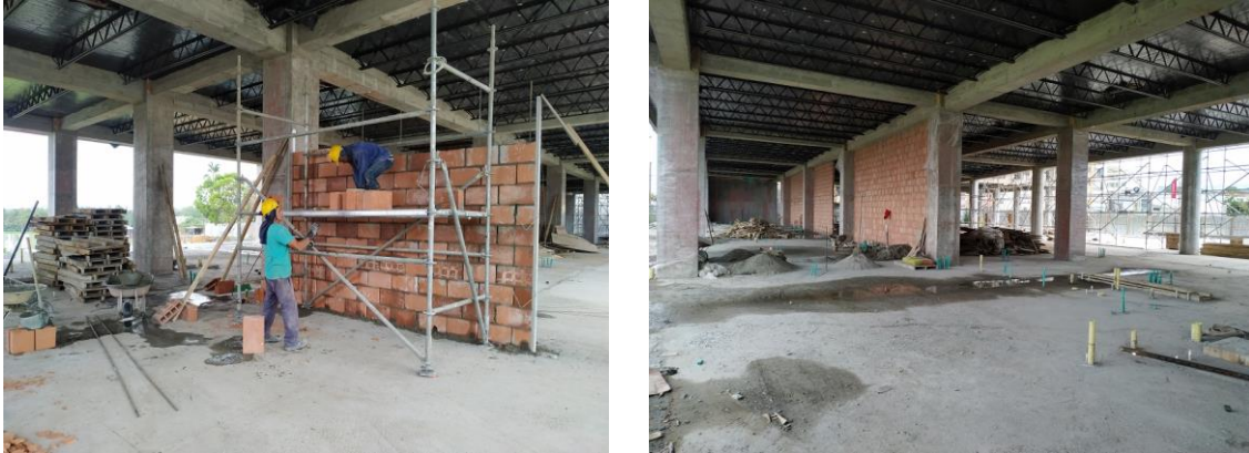
Figura 27 Pega de mampostería locales de primer piso
