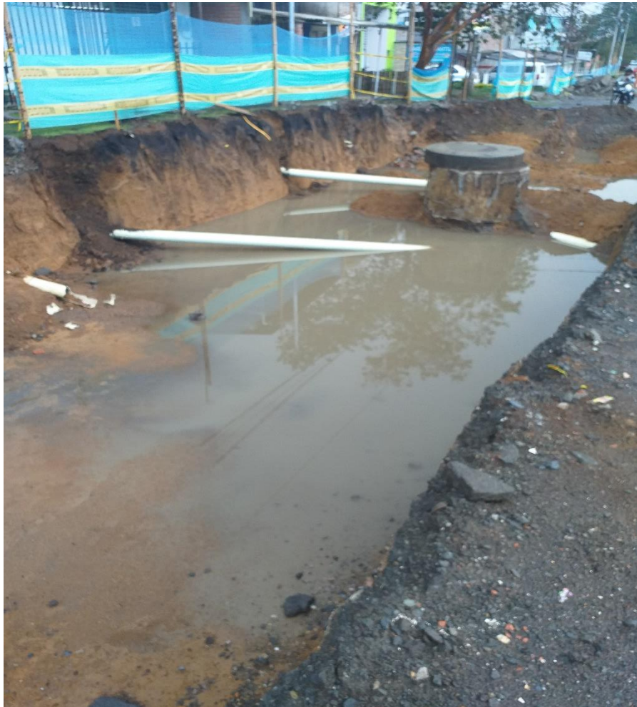
Imagen 39. Tubos de red domiciliaria de alcantarillado sobre el diseño de la sub base.
