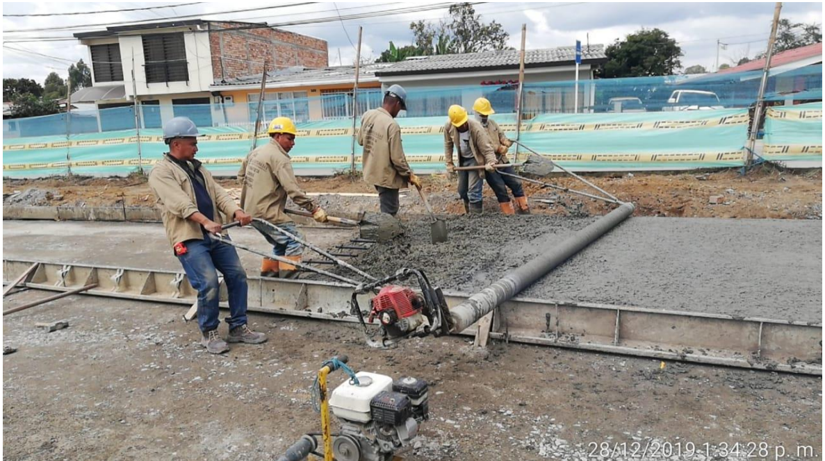
Imagen 21. Utilización de rodillo liso para la nivelación de la mezcla de concreto.
