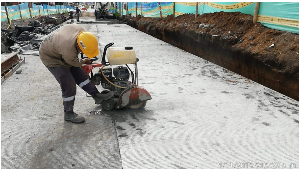
Imagen 31. Equipo con disco de diamante para realizar corte de juntas en losa.
