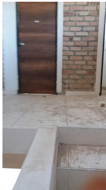
Ilustración 73 Ausencia de sección de guarda escoba
