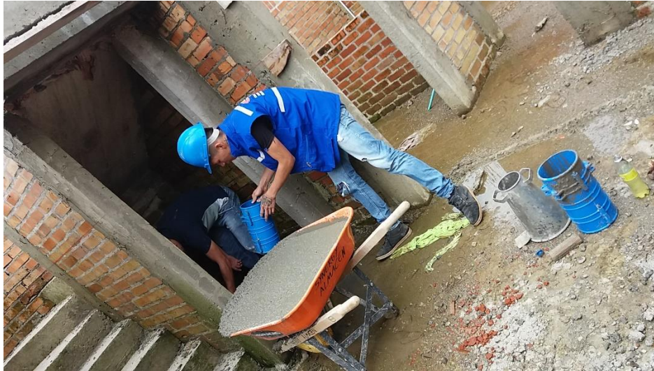
Ilustración 29 Toma de muestras de concreto para realización de pruebas de resistencia a la compresión a concreto de losa aligerada.
