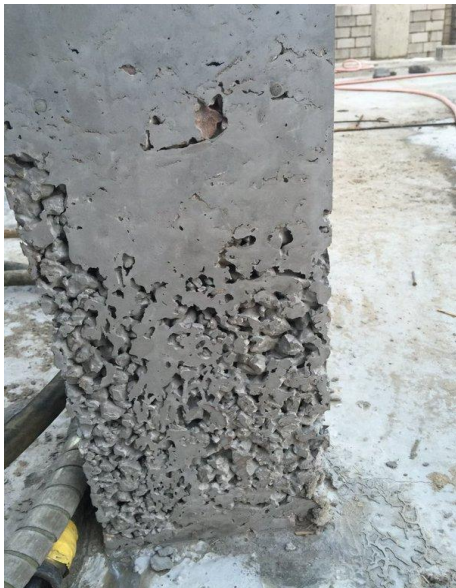
Ilustración 36 Patología del concreto "hormiguero".
