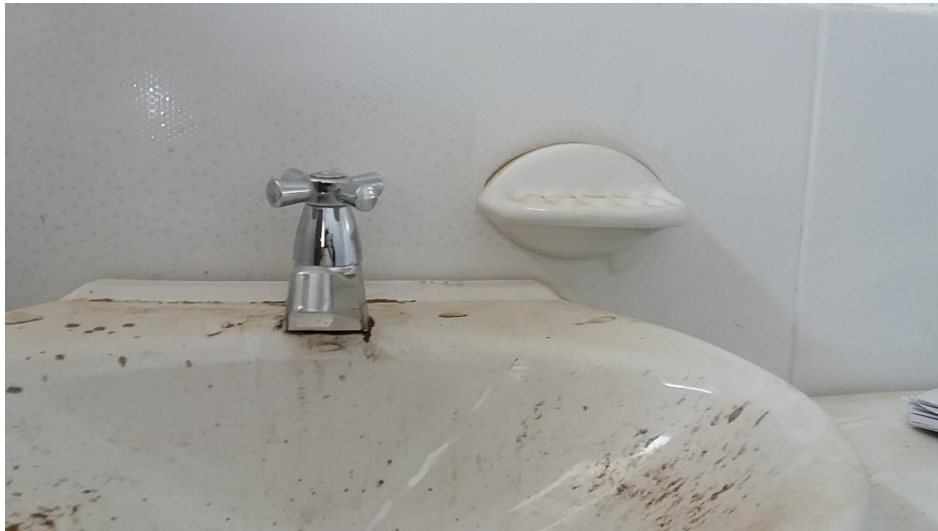
Ilustración 71 Espacio insuficiente entre lavamanos y accesorio
