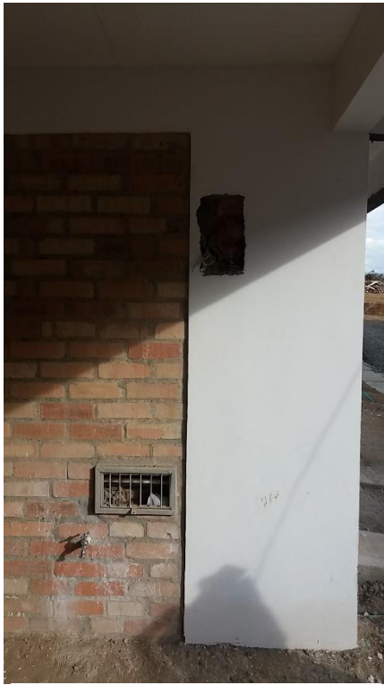
Ilustración 68 Cartera lateral desnivelada
