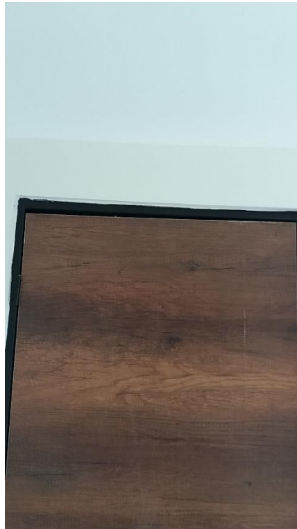
Ilustración 75 Marco de puerta desnivelado
