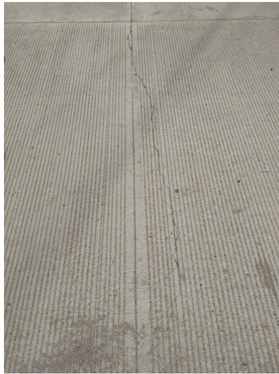
Fotografía 96. Fisura en losa de concreto.
