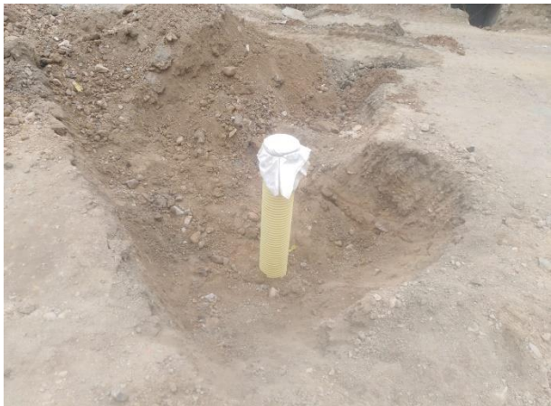
Fotografía 30. Válvula de agua potable, tapada con tuvo.
