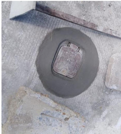
Fotografía 32. Válvula ya instalada.
