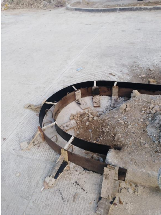
Fotografía 63. Unión bordillo viejo con nuevo por daño en obra, forma curva.
