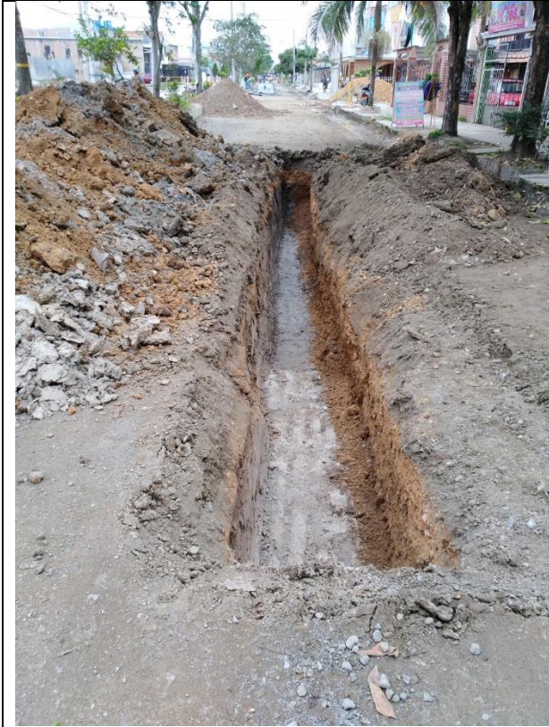
Fotografía 59. Excavación fallo por humedad.
