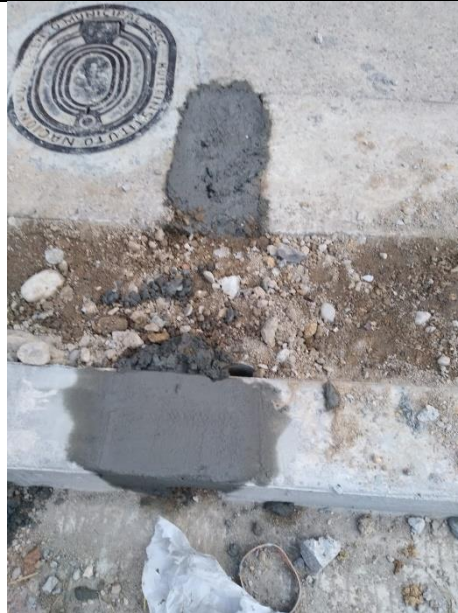
Fotografía 104. Bordillo resanado por bajante de tubería de aguas lluvias.
