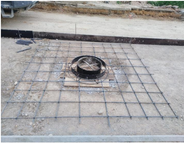
Fotografía 28. Parrilla para pozo instalada.
