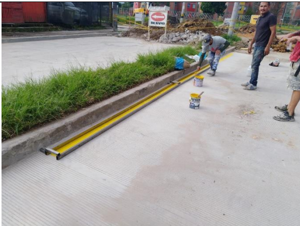
Fotografía 110. Pintura amarilla separador central.
