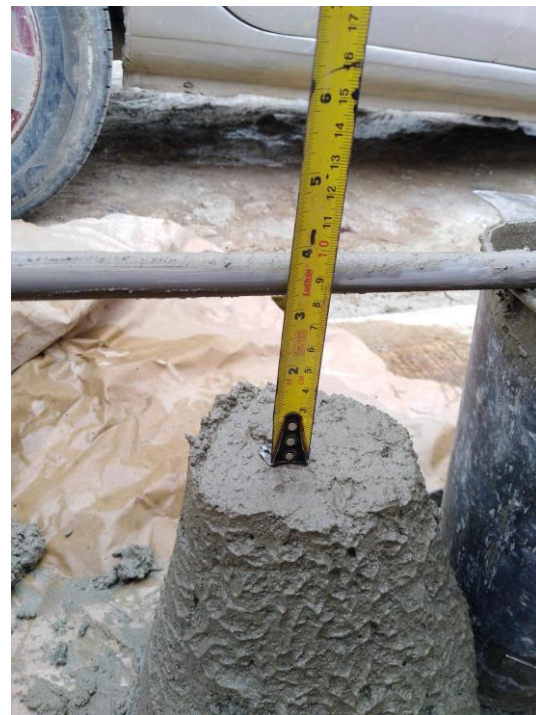
Fotografía 14. Resultado de slump para bordillo en k0+091 -k0+158.5 calzada izquierda lado izquierdo.
