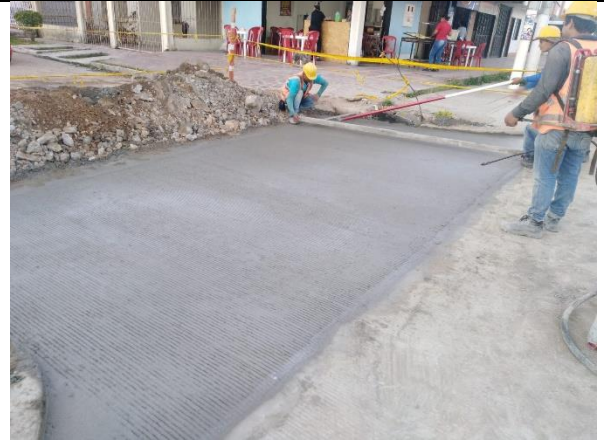
Fotografía 89. Calle 4 calzada derecha boca-calle fundida.
