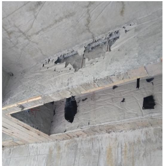
Figura 62. Orificios en viguetas
