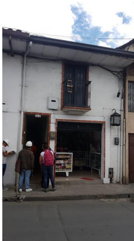
Imagen 124 Fachada edificación ID 382. Fuente: H y C ingeniería Colombia S.A.S
