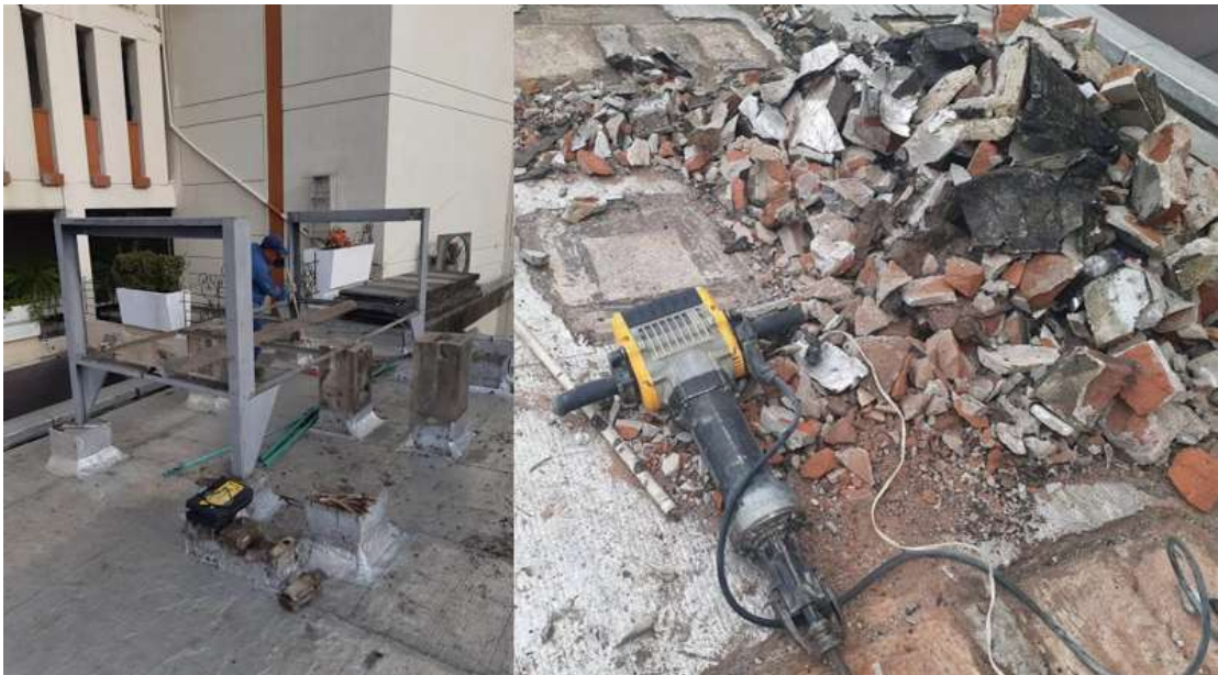
Ilustración 41 Desmonte de condensadores de la antigua red y demolición de pollos. Elaboración propia.
