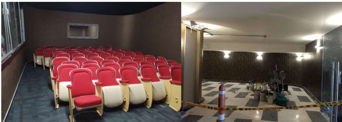
Ilustración 24 Instalación de papel de colgadura en Cuarto Chicoanza y salida de emergencia. Elaboración propia.
