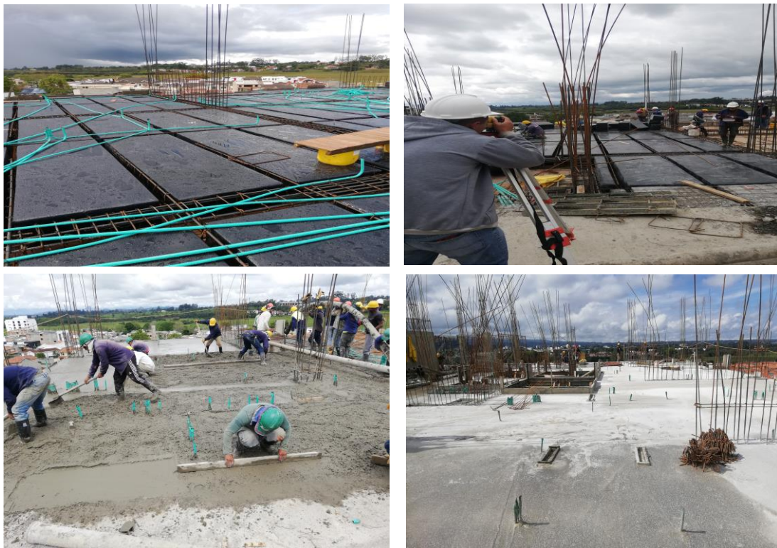
Figuras 23, 24, 25 y 26: Nivelación y fundición de la losa estructural piso 8 Condominio Marsella. Fuente: Propia.
