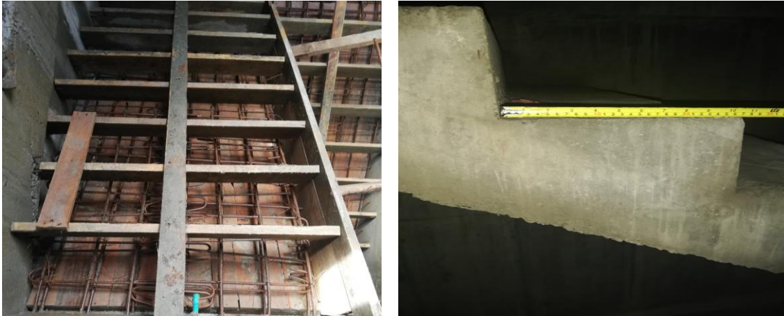
Figuras 18 y 19. Formaleta escalera y chequeo medidas en los escalones de cada tramo.
