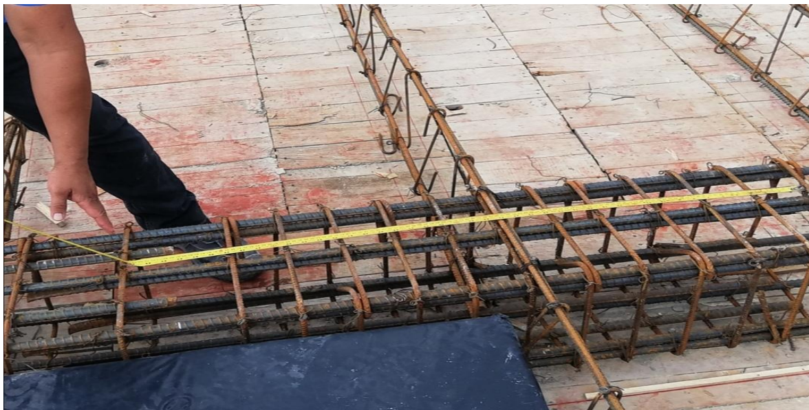
Figura 6. Revisión de longitud de desarrollo en la viga. Fuente: Propia
