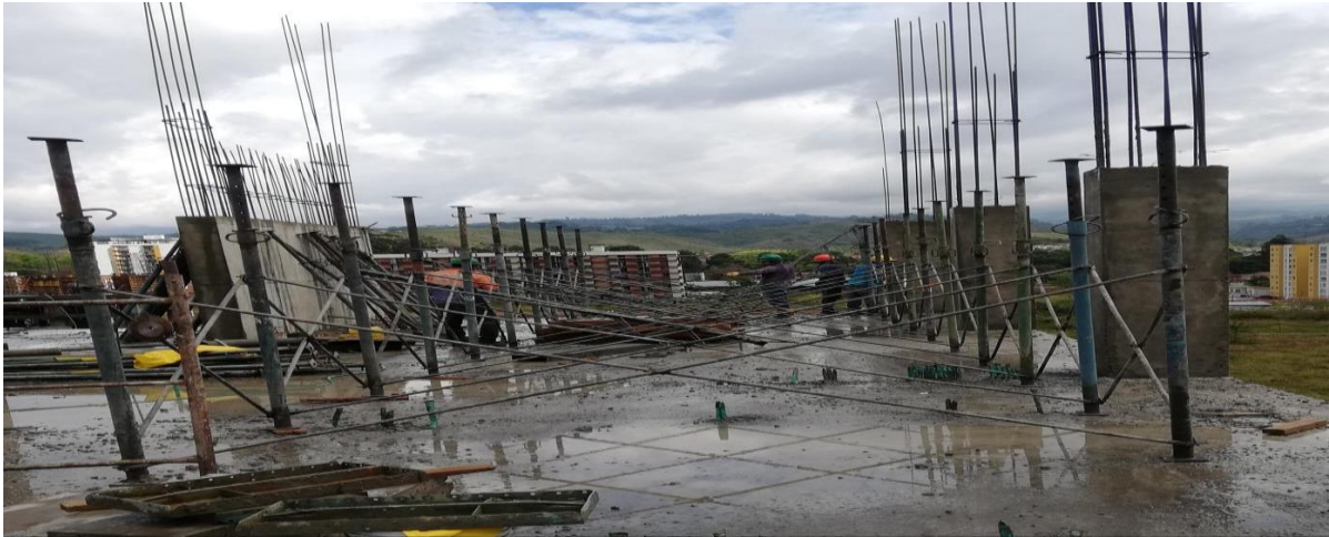
Figura 9. Armado estructura para soporte de la formaleta de la losa. Fuente: Propia
