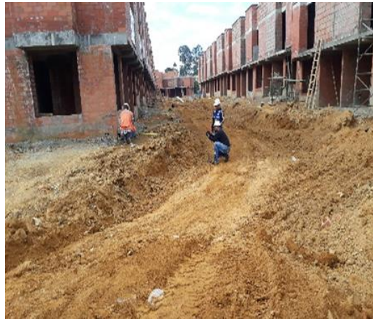
Ilustración 16. Estado de vías de la manzana G Fuente: Autor
