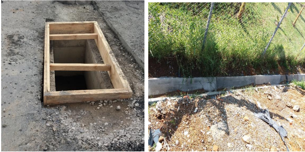
Ilustración 21. Sumideros y canaleta manzana F Fuente: Autor
