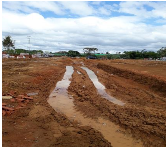
Ilustración 17. Estado de vías de la manzana H Fuente: Autor
