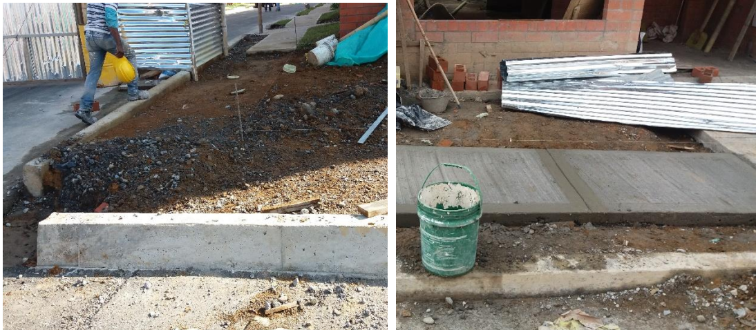
Ilustración 8. Mal vibrado del concreto (hormigqueo) fuente: autor
