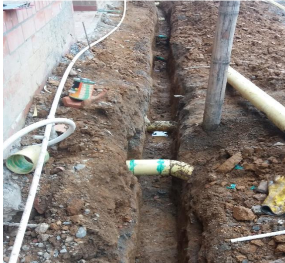
Ilustración 29. Daños en la tubería Fuente: autor
